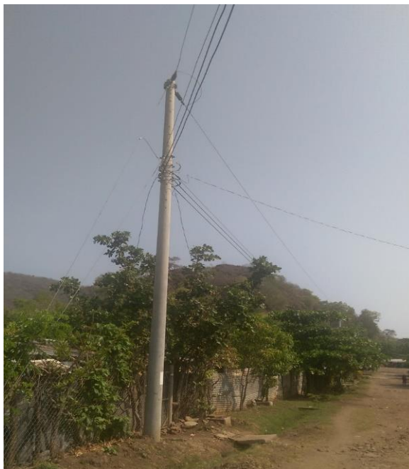
Figura 61. Poste de tensión eléctrica
