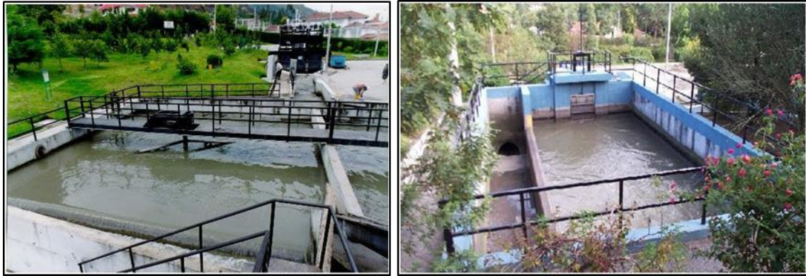
Figura 40. Tanques de tratamiento de aguas residuales
