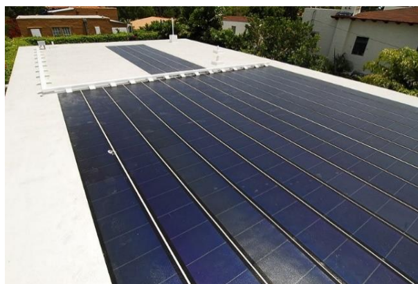
Imagen N° 59 Sistema de paneles fotovoltaicos simples
