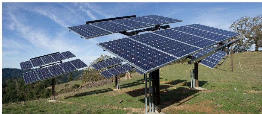
Imagen N° 60 Paneles fotovoltaicos altamente eficientes
