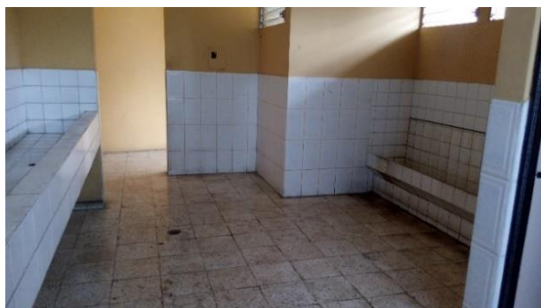
Imagen N° 43 Estado de los Servicios Sanitarios para el público general
