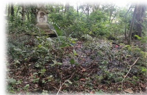
Imagen 79: Estancamiento de aguas grises entre los sepulcros
