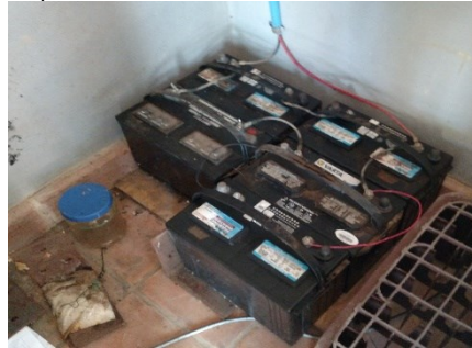
Ilustración 243 Baterías para almacenamiento.
