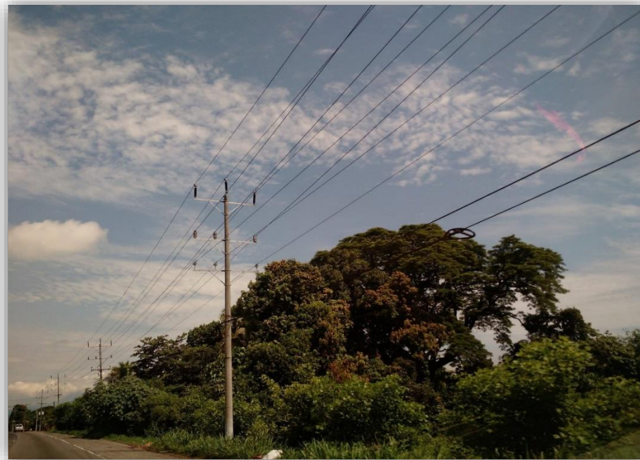
Fig. 52: Línea Aérea de Distribución Ateos-Lourdes.
