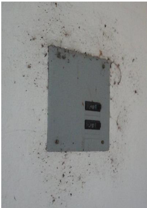
Fotografía ADI-8. Instalación energía eléctrica existente en el inmueble, tablero.
