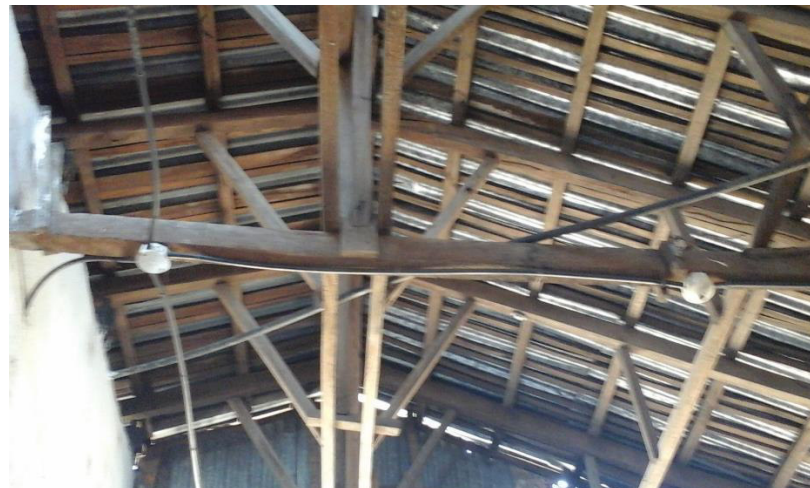
Fotografía ADI-10. Instalación energía eléctrica existente en el inmueble.
