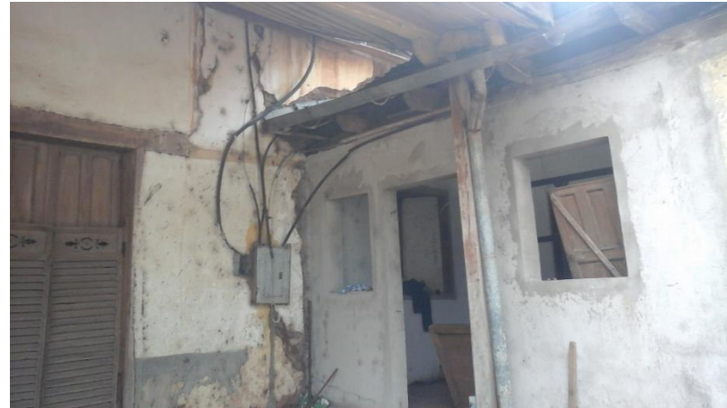
Fotografía ADI-9. Instalación energía eléctrica existente en el inmueble.
