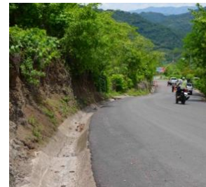
Imagen 4.5 Canaleta de A.L.L. Fuente propia
