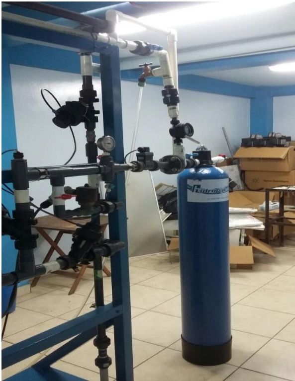
Anexo 9. Sistema purificador de agua reestructurado.
