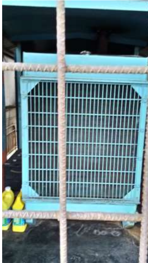
Imagen 4.53 Generador de 166 KVA
