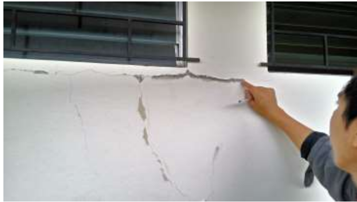
Imagen 4.25 Grietas en módulo de cirugía
