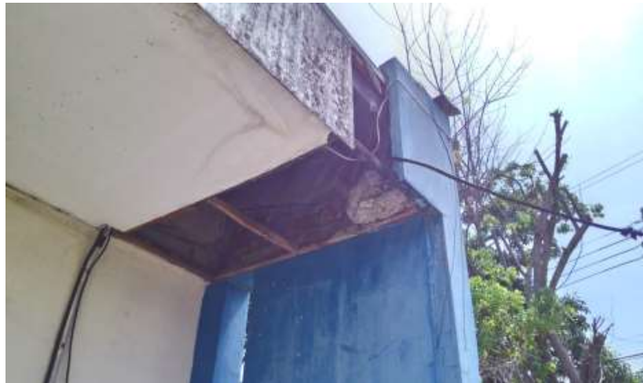
Imagen 4.38 Canaleta inservible en módulo de cocina y lavandería
