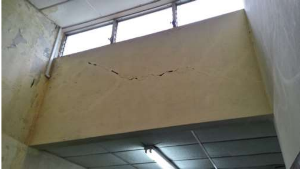
Imagen 4.41 Grieta en lavandería
