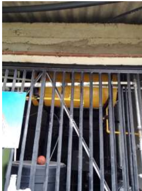
Imagen 4.57 Tanque de abastecimiento de calderas.
