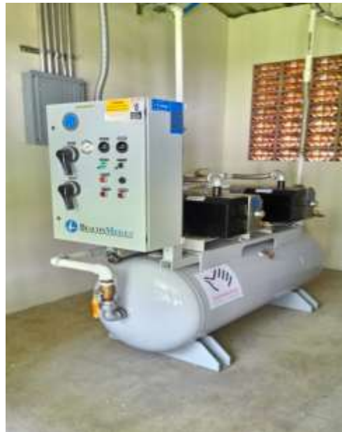
Imagen 4.60 Tanque de Vacío
