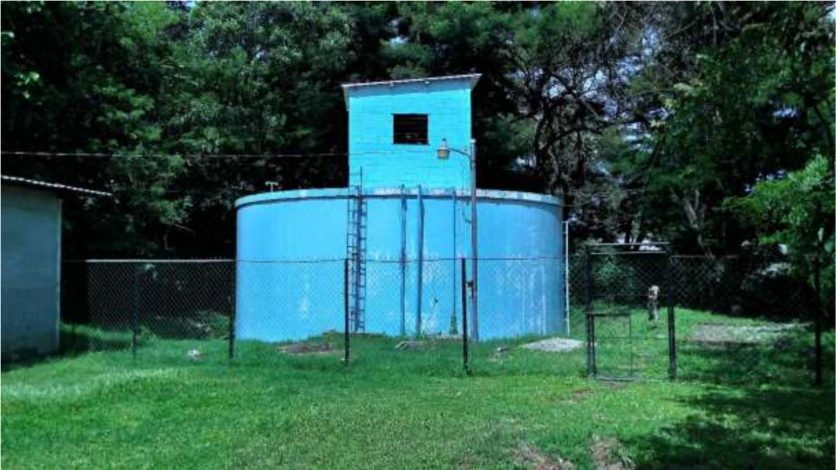
Imagen 4.55 Tanque de abastecimiento de agua del Hospital.
