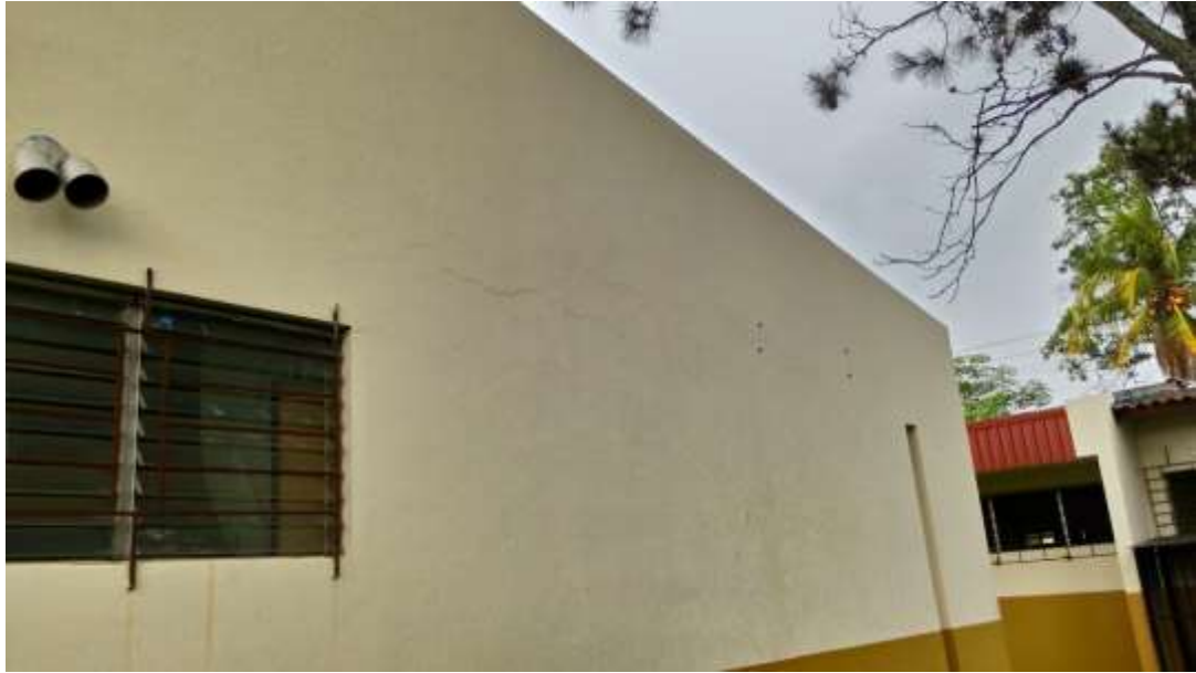
Imagen 4.23 Grietas en módulo de laboratorio clínico.
