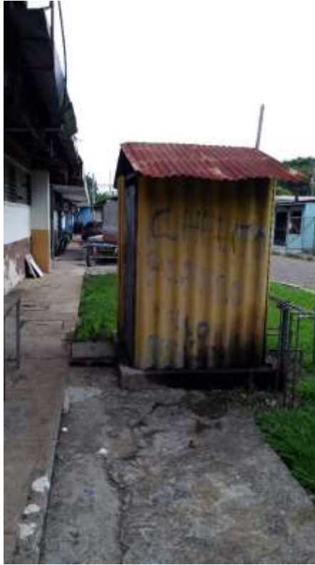
Imagen 4.56 Caseta de bomba de tanque subterráneo.
