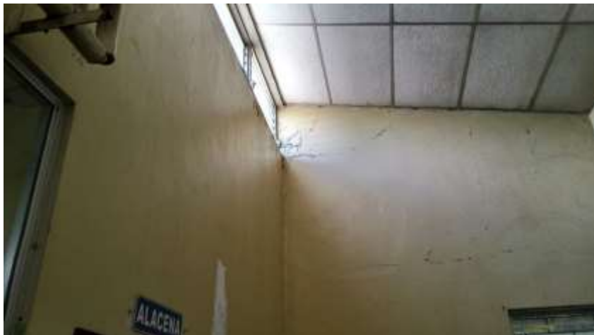
Imagen 4.40 Grietas en cocina
