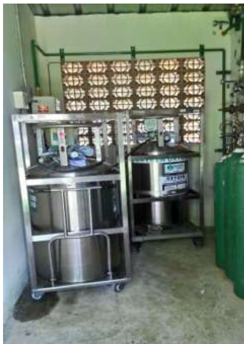
Imagen 4.58 Tanques de Oxígeno Líquido
