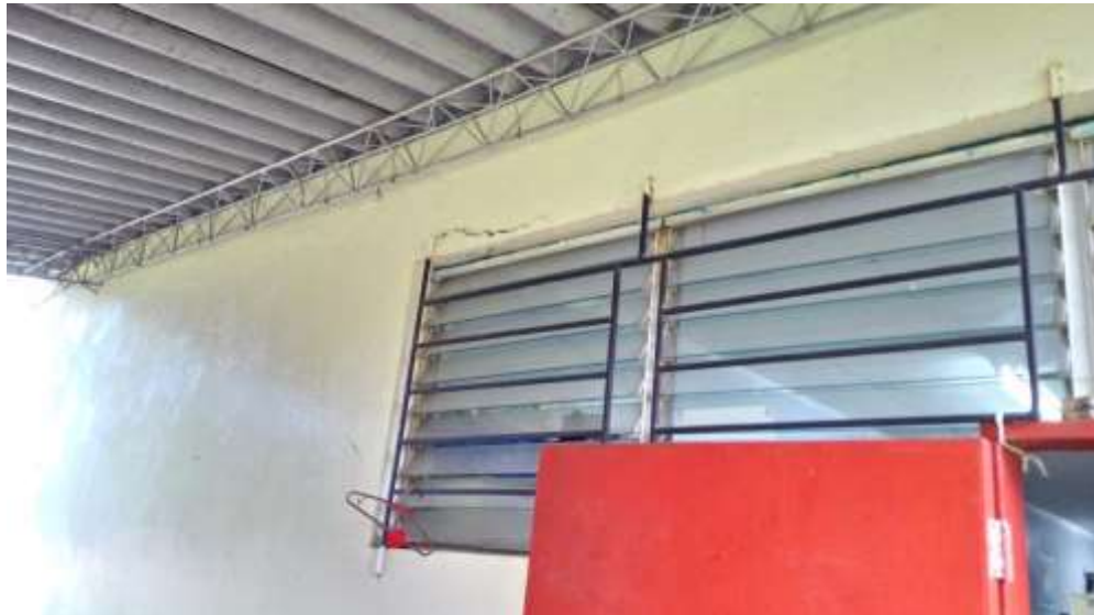
Imagen 4.36 Marco de ventana deteriorado.
