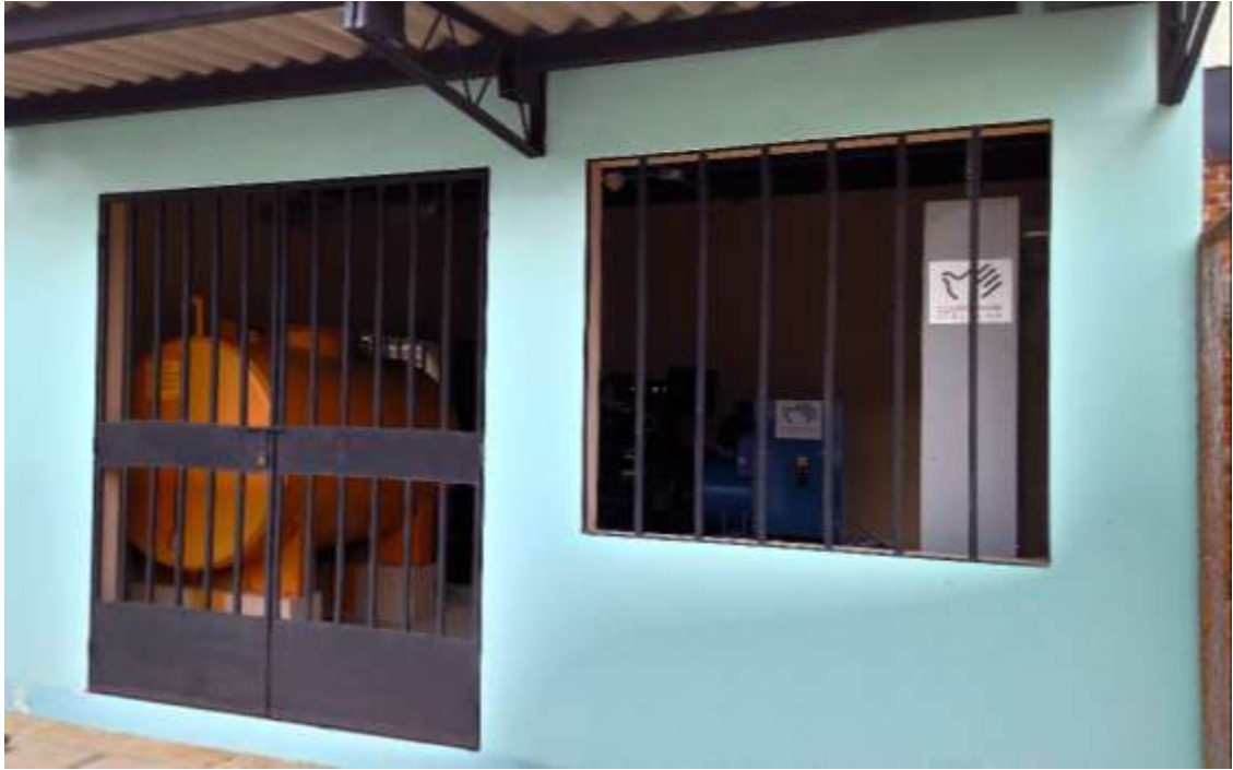
Imagen 4.49 Caseta protectora para generador de 250 KVA
