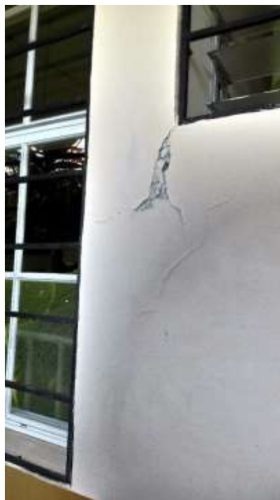
Imagen 4.32 Grietas en el módulo de pediatría
