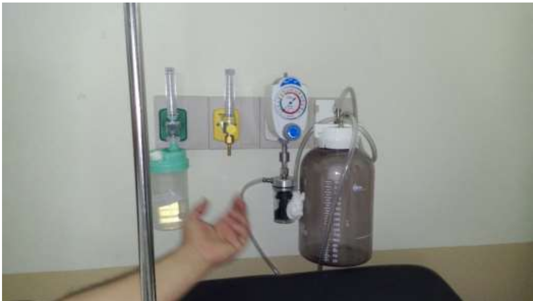
Imagen 4.62 Salida de suministro de gases medicinales
