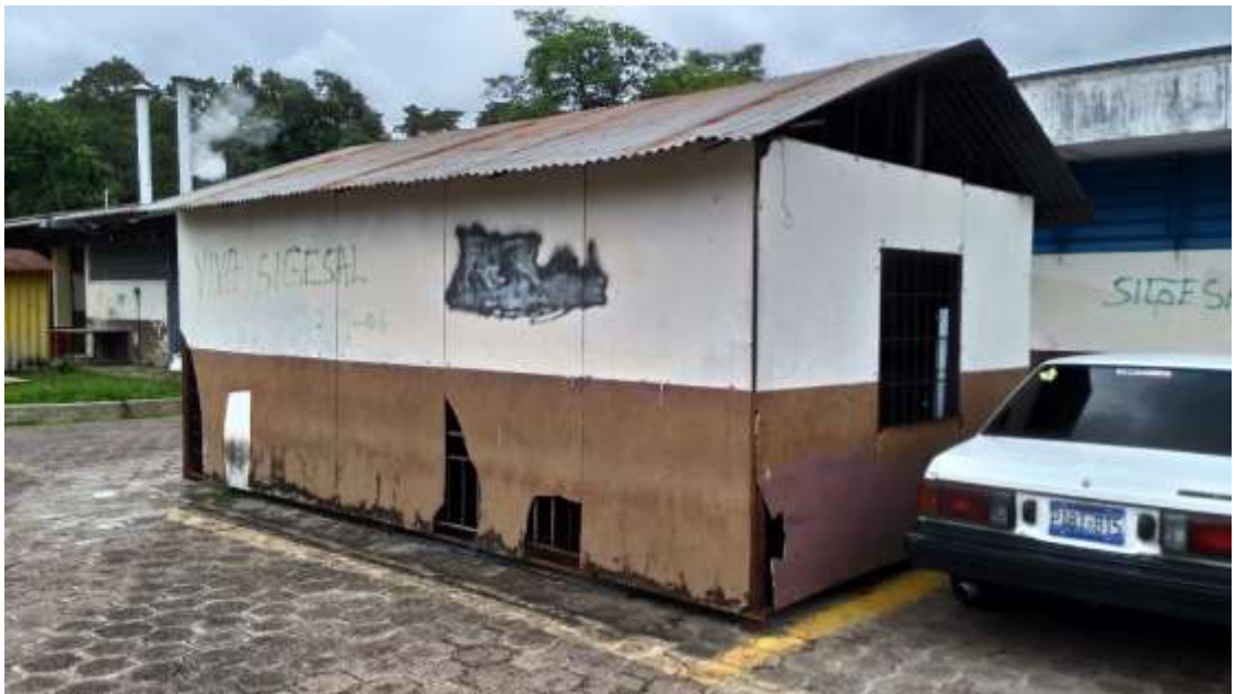
Imagen 4.50 Caseta protectora para generador de 166 KVA
