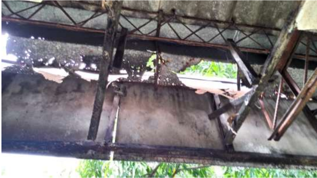
Imagen 4.39 Canaleta de lavandería inservible
