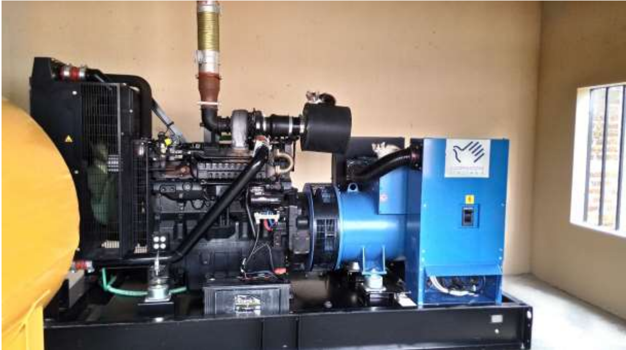
Imagen 4.52 Generador de 250 KVA
