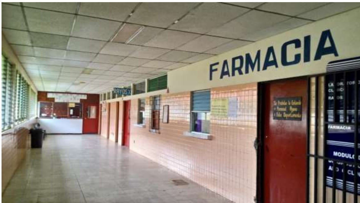
Imagen 3.14 Pasillo de Farmacia, rayos x y laboratorio clínico
