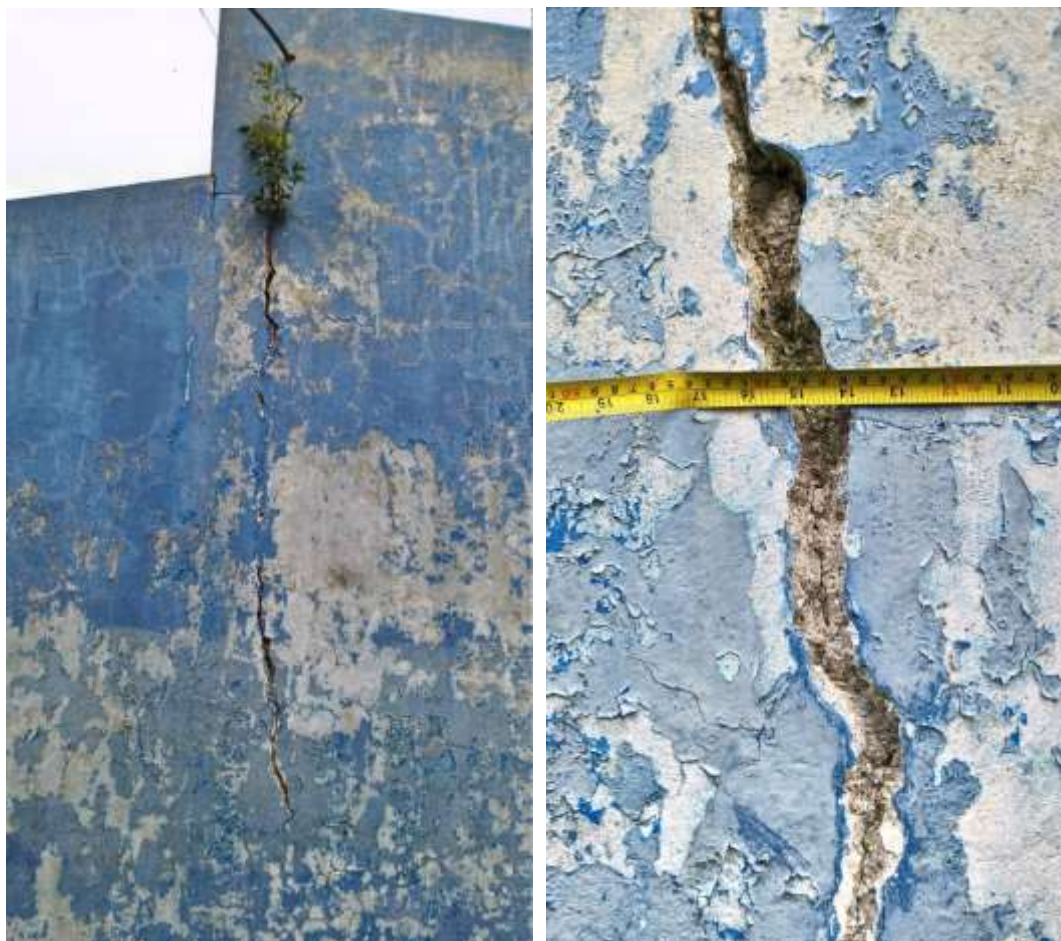
Imagen 4.41 Espesor de grieta en el área de lavandería
