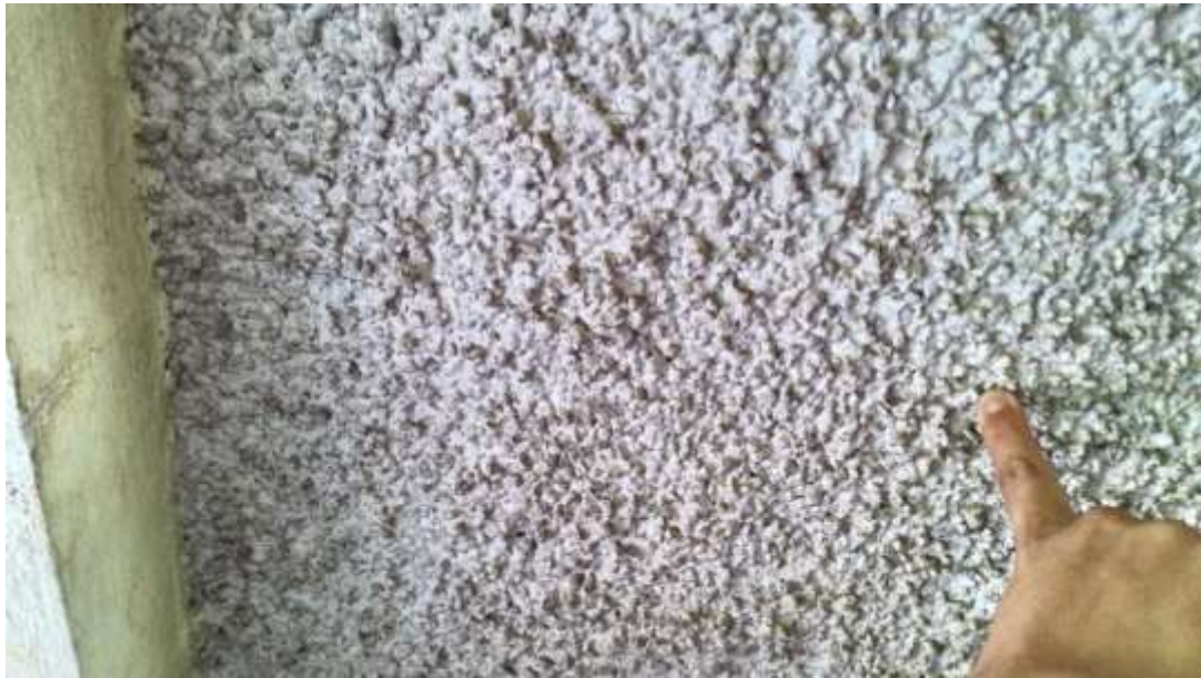
Imagen 4.11 Grietas de las losas
