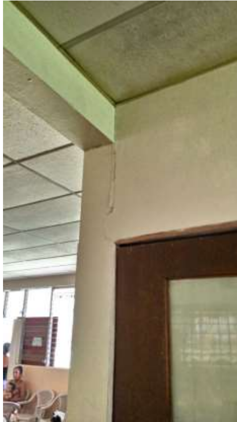
Imagen 4.19 Grieta sobre puerta en consulta externa
