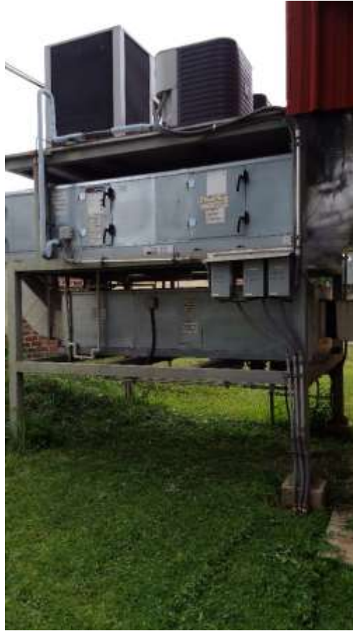
Imagen 4.64 Aire acondicionado de la zona de cirugía
