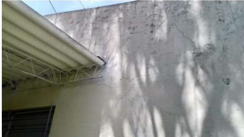
Imagen 4.35 Grietas en el edificio de medicina y cirugía.
