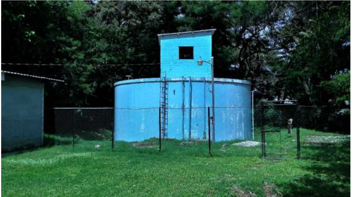
Imagen 3.17 Tanque de agua para abastecer al Hospital Nacional de Chalchuapa
