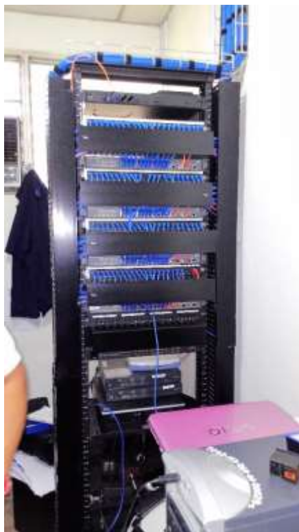
Imagen 4.54 Red física de telecomunicaciones.
