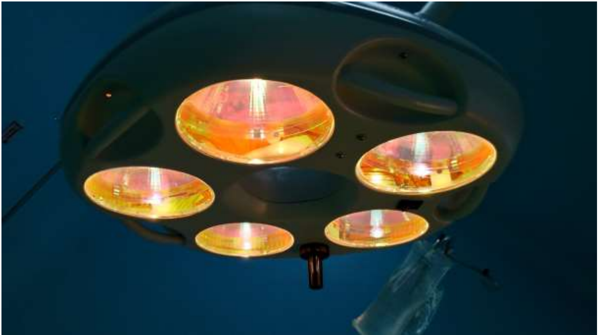
Imagen 4.69 Sistema de iluminación de los quirófanos.
