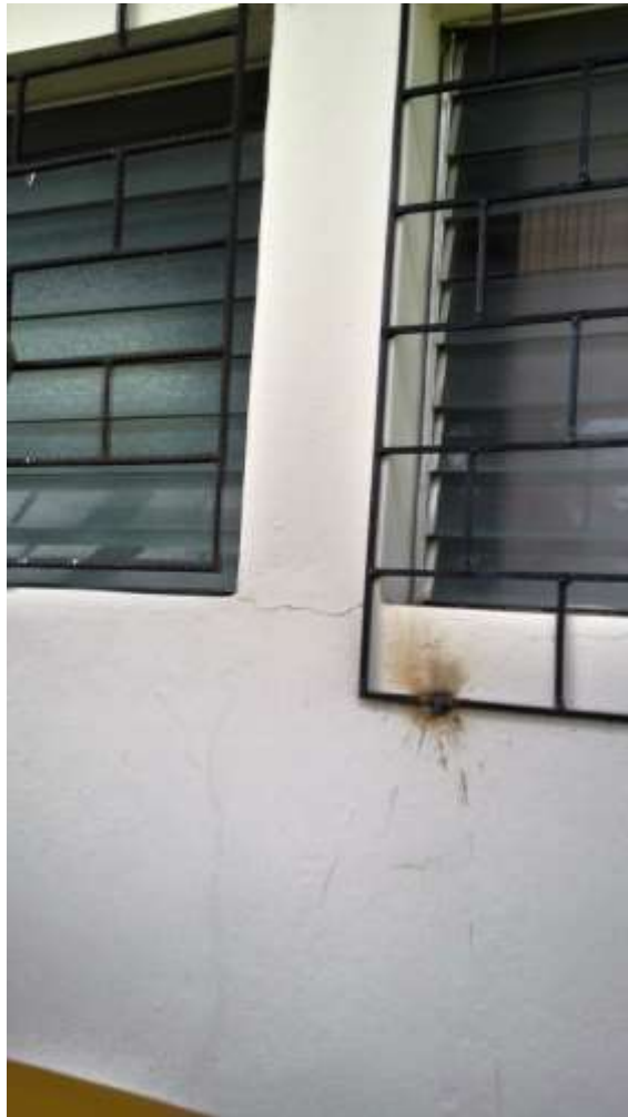
Imagen 4.18 Grietas en módulo de consulta externa
