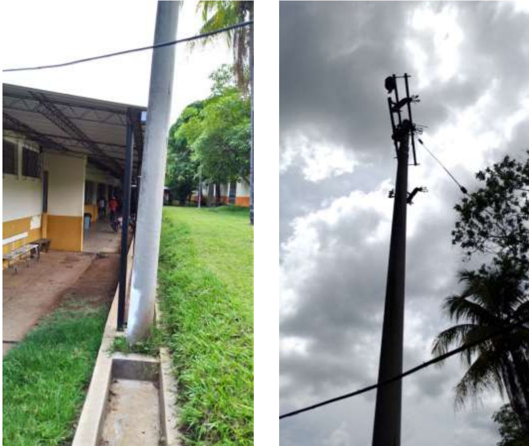
Imagen 4.12 Poste cercano a cafetín
