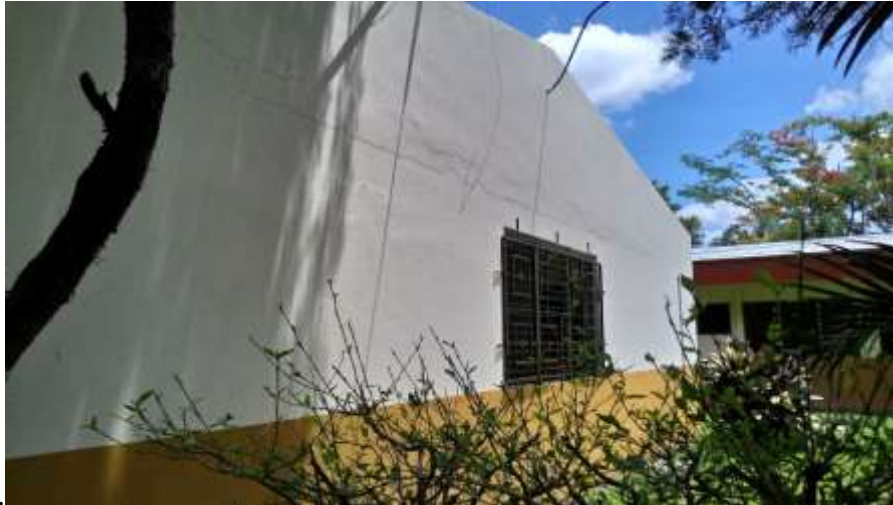
Imagen 4.16 Grieta en módulo de consulta externa y dirección.
