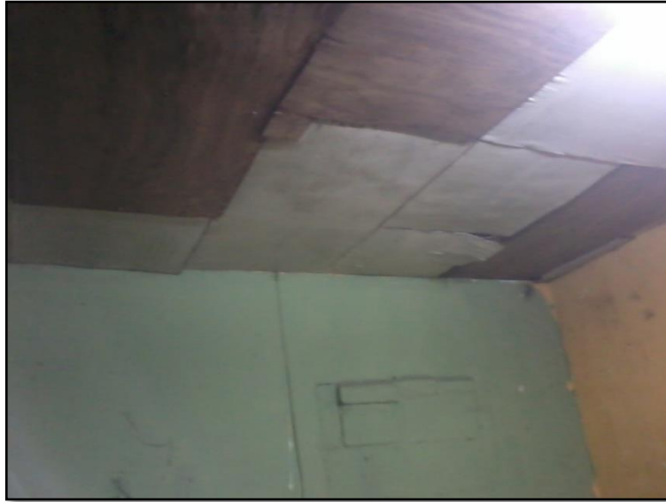
Figura 5.31 Estado actual del cielo falso, hay presencia de humedad y pudrición.
