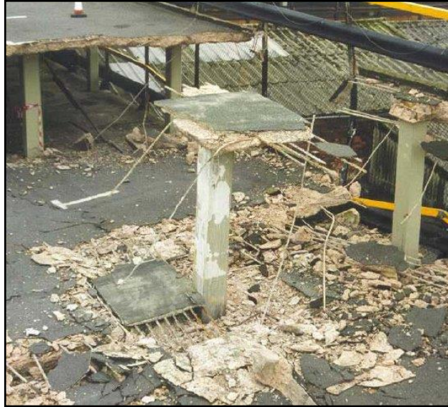
Figura 3.12 Fallas por Punzonamiento en Losas.
