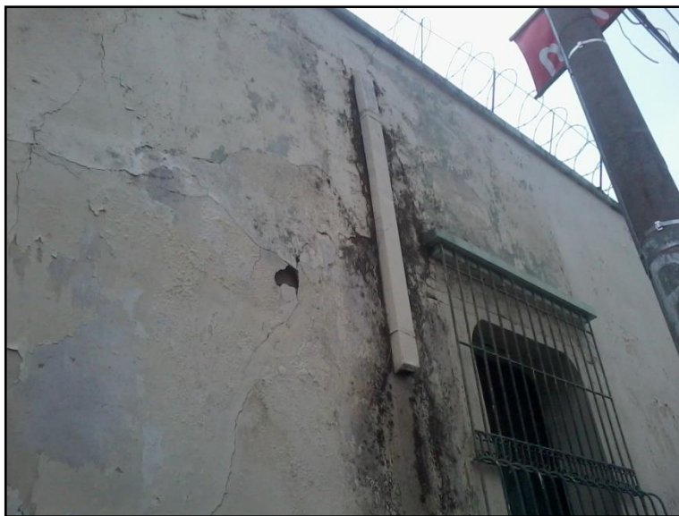
Figura 5.27 Vista exterior de aula, se observan las grietas y la humedad proveniente del techo.
