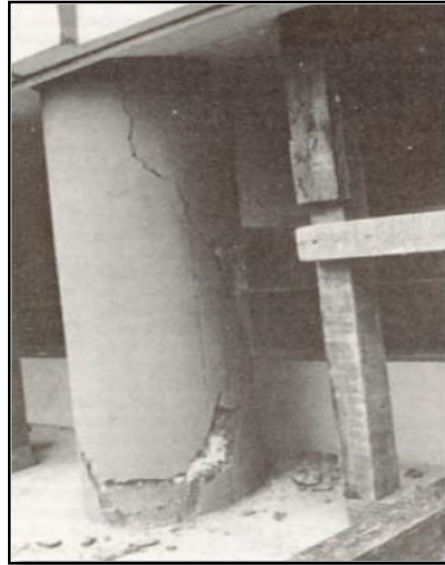
Figura 3.10 Fallas por Torsión en Columnas.
