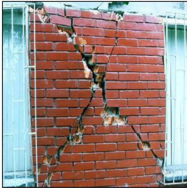
Figura 3.13 Fallas por Corte en muros
