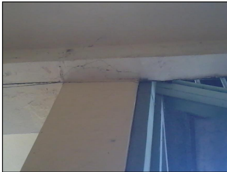
Figura 5.13 Vista la junta entre edificaciones y fisuras en la parte de la viga que esta frente a la columna.
