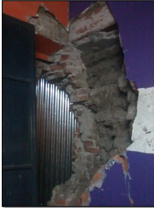
Figura 5.29 Zona de colisión en la edificación evaluada. El agujero ha sido ocultado con lámina ondulada.
