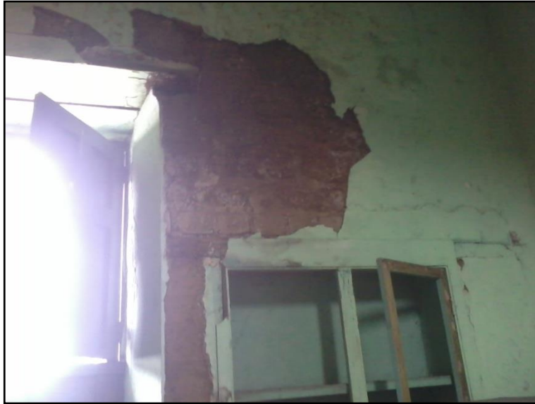
Figura 5.26 Vista interna de aula de la esquina de la 4ª C.P. y 2ª Av. Sur. Se observa el desprendimiento del repello.
