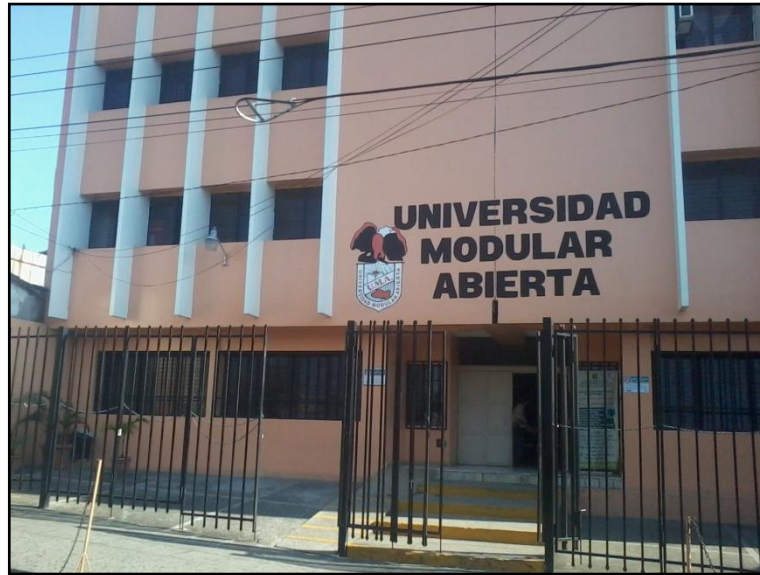
Figura 5.5 Muestra la fachada principal de la universidad, se puede apreciar la junta de dilatación.
