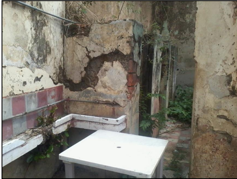
Figura 5.10 Vista de daños en las paredes y huecos de puertas.
