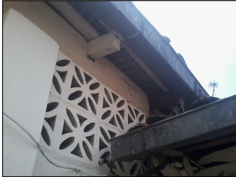
Figura 5.8 Vista parcial de los cargaderos que sostienen la estructura de techo, tiene algunos daños por insectos y pudrición interna.
