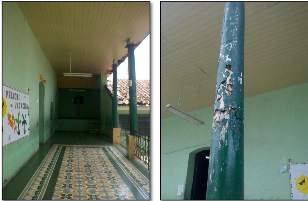
Figura 5.24 y Figura 5.25 Muestra el pasillo de la edificación en cuestión y el estado de algunas columnas de madera.
