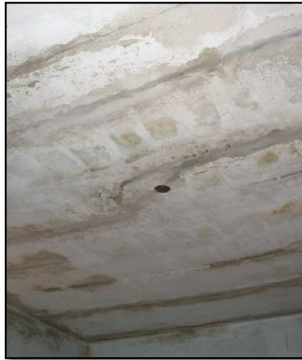
Figura. 3.11 Fallas por Flexión en Losa Aligerada, se puede observar grietas a lo largo de las viguetas.
