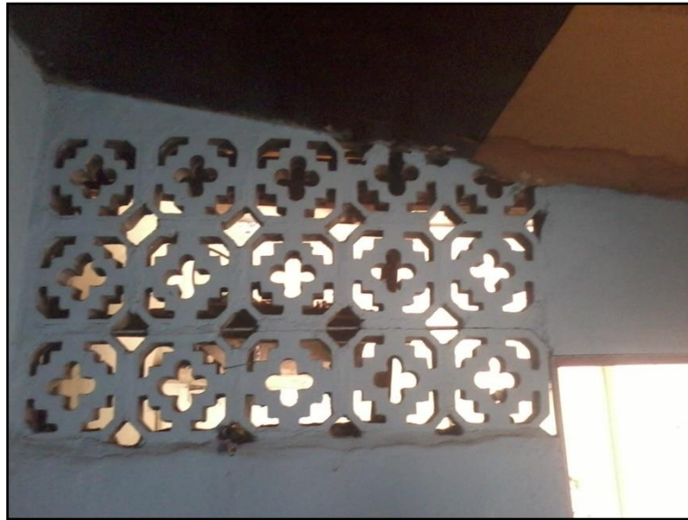
Figura 5.7 Muestra la parte alta de la puerta solamente sostenida por un angular de hierro de 1” a un nivel distinto del ventanal. También se observa el estado del cielo falso en deterioro
