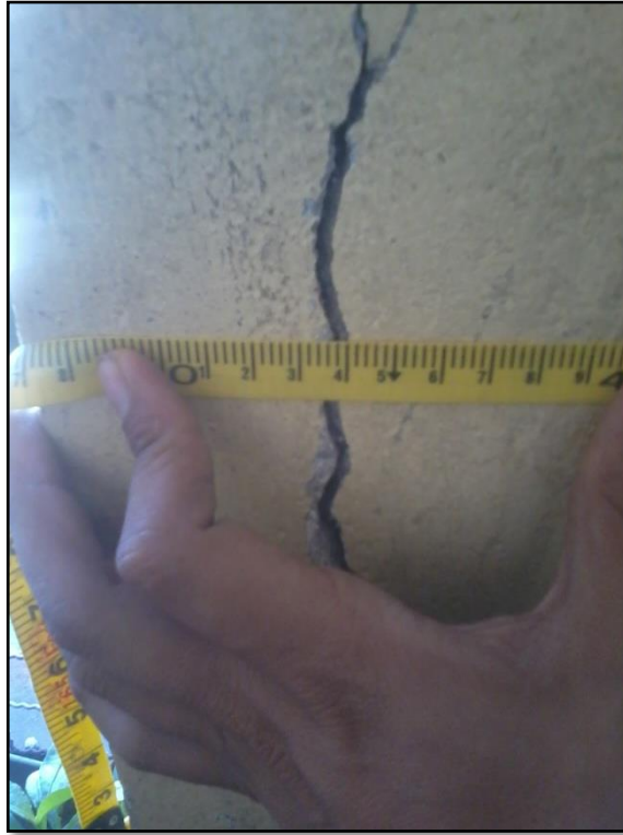
Figura 5.12 Acercamiento de grietas en columna del segundo nivel.
