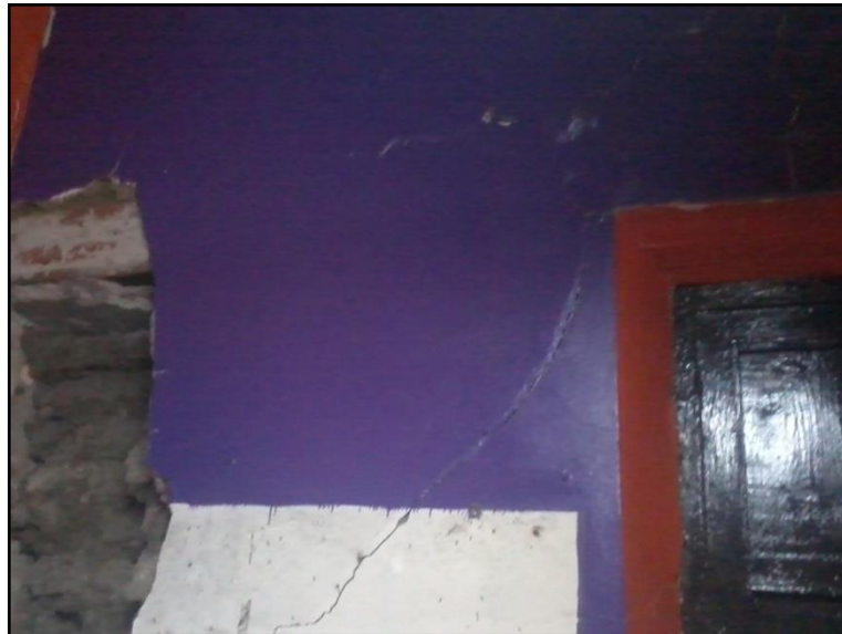
Figura 5.30 Grieta proveniente de la colisión cercana a puerta aledaña.
