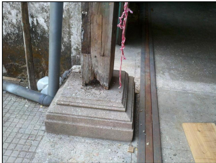
Figura 5.17 Pilares que sostienen el pasillo del segundo nivel, se puede apreciar que no existe un área de contacto constante con el pedestal.
