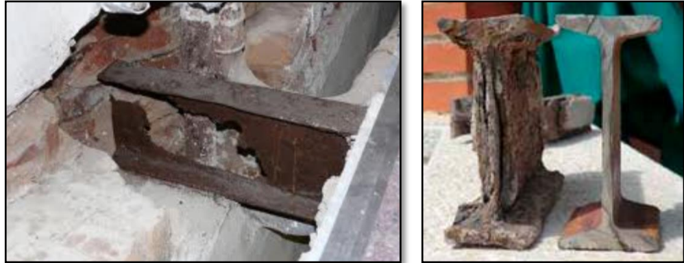
Figura 3.19. Ataques de corrosión en acero
