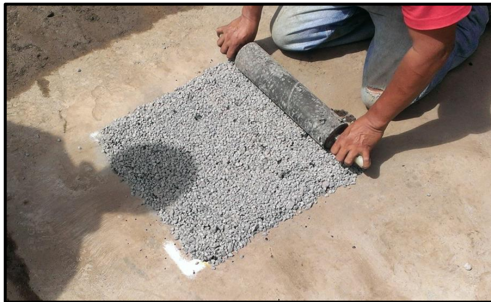
Segunda capa de agregado \frac{3}{4} " sobre segunda capa de emulsión para luego ser compactada.
