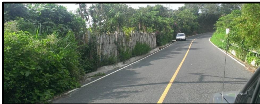
FIGURA # 2. 8 Condiciones actuales de la superficie de la carretera.
