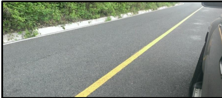
FIGURA # 2. 7 Condiciones actuales de la superficie de la carretera.
