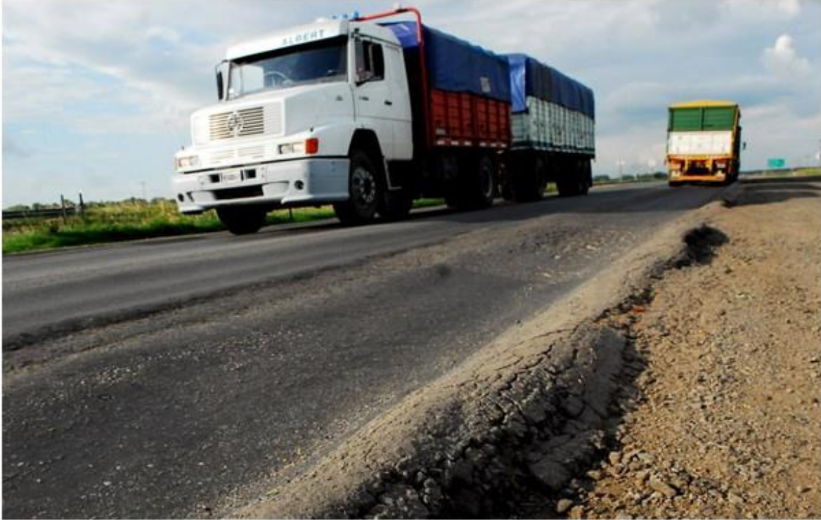
Figura 2.21 ahuellamiento en capas subyacentes.
