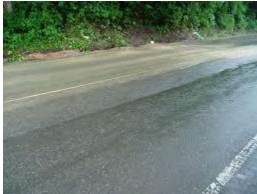
Figura 2.20 ahuellamiento superficial presente en la capa asfáltica.
