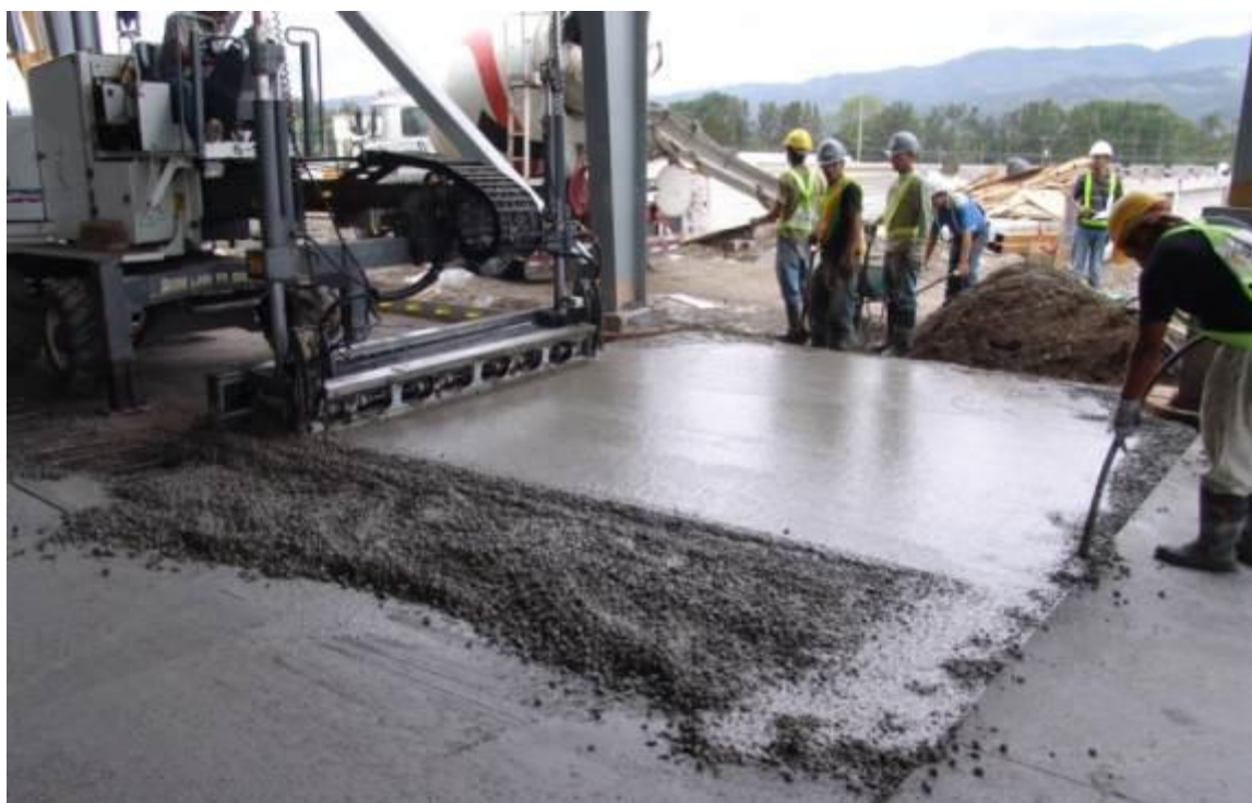
Figura 2.8.17. Imagen común de concreto exudando en la obras.
