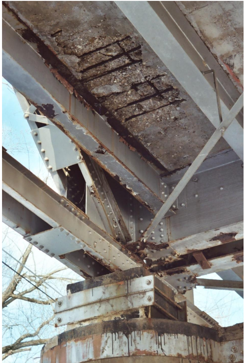
Figura 2.8.7. Devil's Elbow Bridge en Missouri, Estados Unidos afectado por ataques químicos, con sus losas de concreto deterioradas por la permeabilidad y la posterior corrosión del acero.
