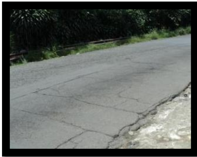
Figura # 5.4 Fallas en bordes.
