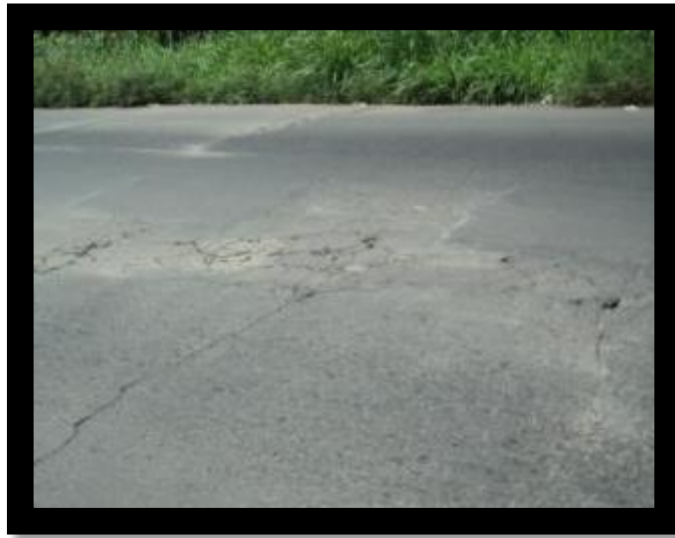
Figura # 5.5 Agrietamiento por fatiga.
