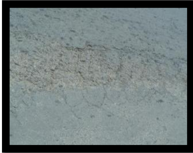
Figura # 5.6 Pérdida de agregado.
