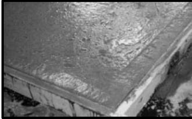
Figura 2.23 Agua de sangrado en la superficie de una losa.
