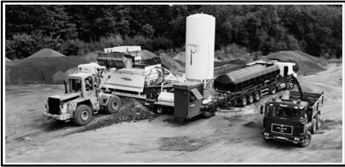
Figura 3.11: Planta mezcladora Wirtgen KMA 200
