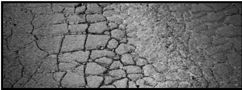
Figura 2.6: Típico deterioro de pavimento por fatiga y con presencia de bombeo de finos
