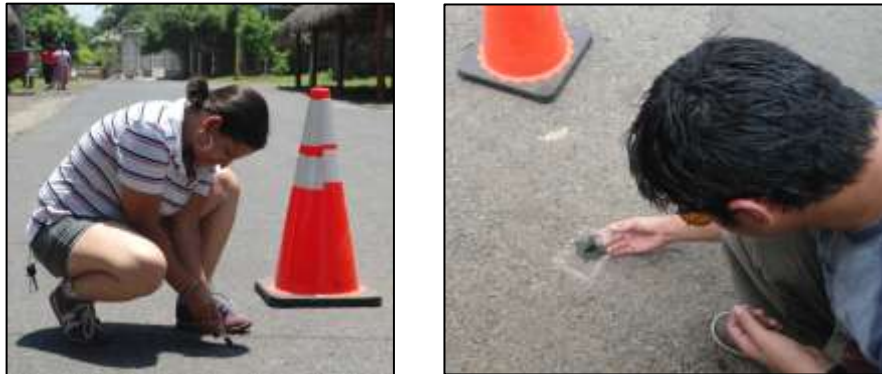
Figura 3.6. Zona de medición carretera a Cerro Verde departamento de Santa Ana. Integrantes del grupo de investigación vertiendo aceite térmico dentro de los agujeros previamente perforados.
