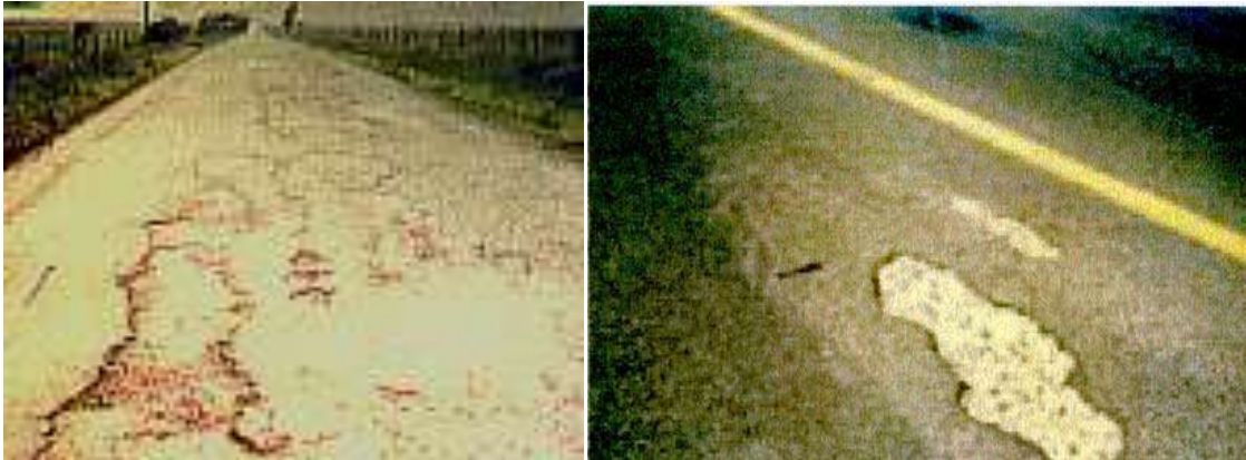
Figura 2.20 Segregaciones en pavimentos asfálticos. (MEZCLAS ASFÁLTICAS, ALEJANDRO PADRILLA RODRIGUEZ, PAG 56)
