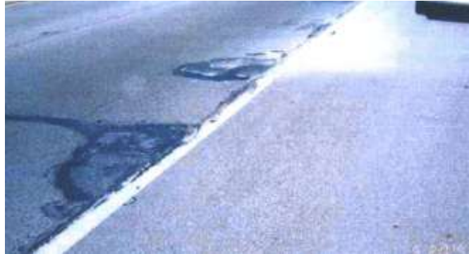
Figura 2.24 Bombeo de finos en pavimentos asfálticos. (MEZCLAS ASFÁLTICAS, ALEJANDRO PADRILLA RODRIGUEZ, PAG 61)
