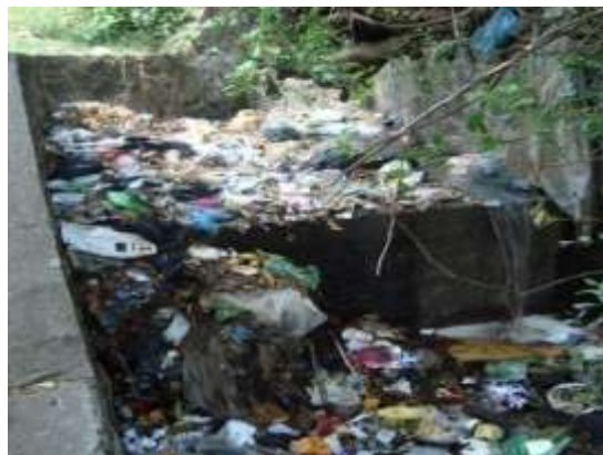
Foto. 4.2 Acumulación de desechos sólidos en bóveda ubicada al final de col. Zapote Injerto.
