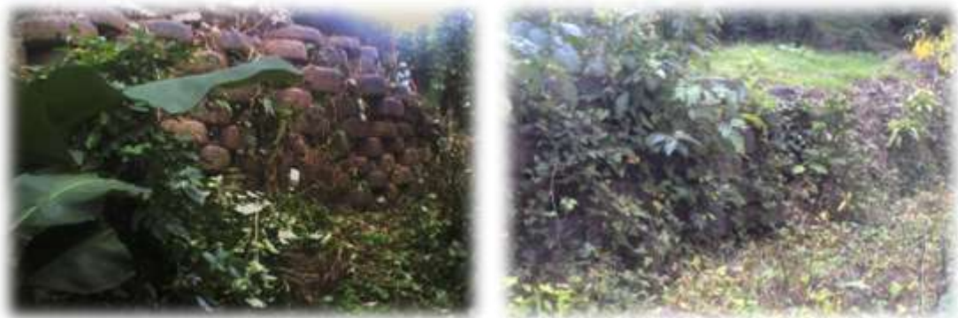
Imagen 2.05 Muro de Retención hecho de llantas enteras, Comunidad “Tigre I”, Municipio de Apáneca, Departamento de Ahuachapán.
