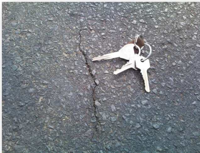
FIG. 5 8 GRIETAS EN LA SUPERFICIE
