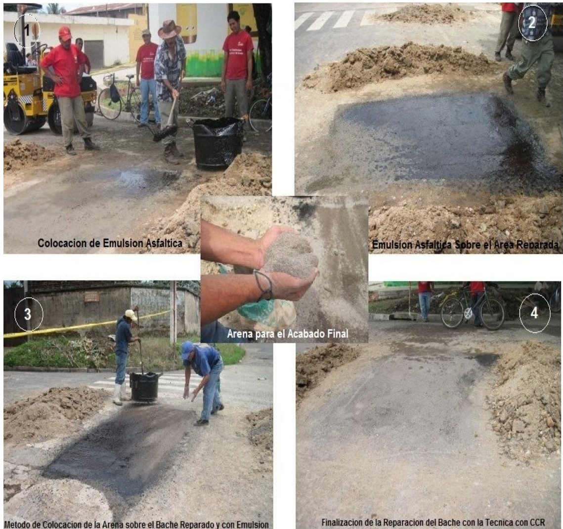
Figura N° 4.8 Secuencia del Curado y Acabado Final del Proceso de Bacheo. Fuente: Grupo de Tesis.
