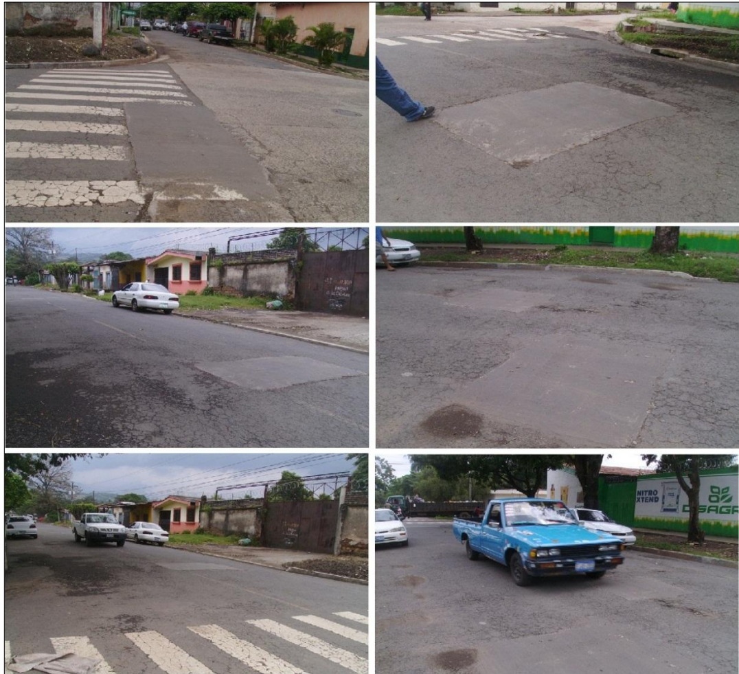
Figura N° 4.13 Inspección Visual a 30 Días del Bacheo. Fuente: Grupo de Tesis, CCR para Bacheo.
