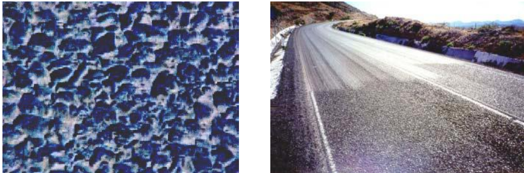
Fotografías 2.11. Textura superficial inadecuada en pavimentos asfálticos 28 .
