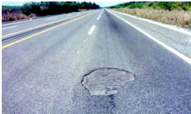
Fotografías 2.9. Segregación Transversal en Pavimento Asfáltico 26 .
