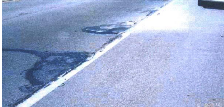
Fotografías 2.13. Bombeo de finos en pavimentos asfálticos 30 .
