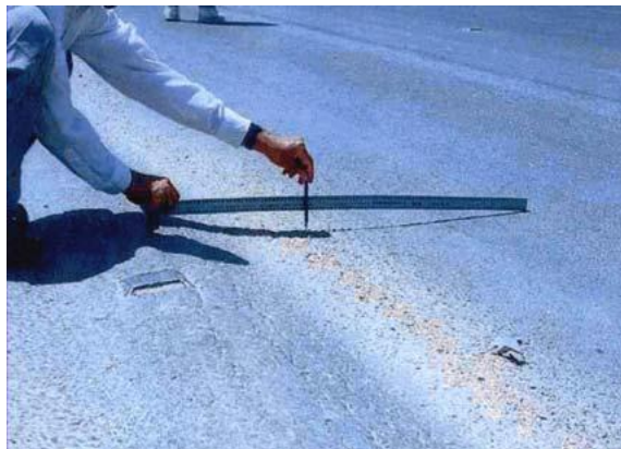
Fotografía 2.14. Deformación plástica permanente en pavimento asfáltico 31 .
