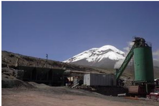
Fotografía 2.1 Planta de asfalto continua de flujo paralelo 18 .
