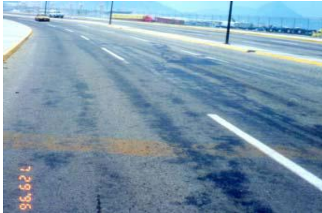
Fotografías 2.8. Exudación en pavimento asfáltico 25 .
