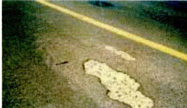
Fotografías 2.10. Segregación longitudinal en pavimento asfáltico 27 .
