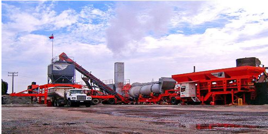
Fotografía 2.3 Planta Asfáltica de secado a contra flujo 20 .
