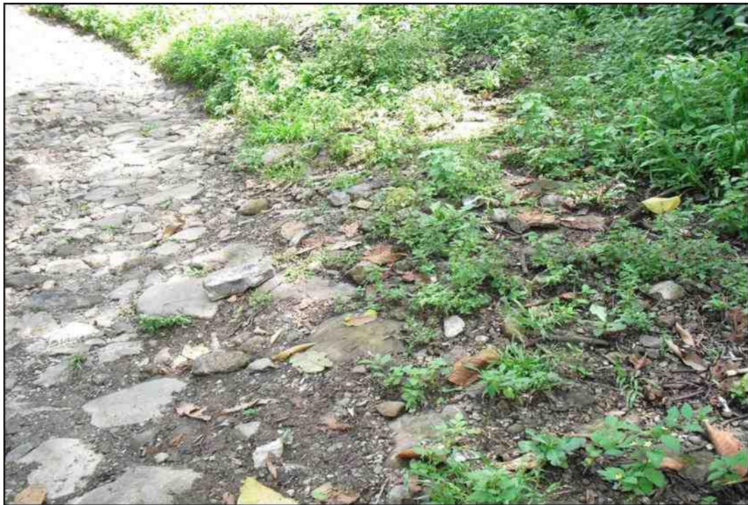
Anexo 2: Caminos sin obra de drenajes.
