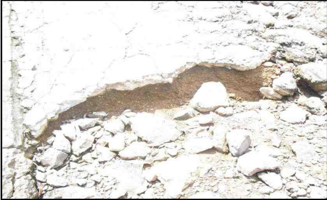
Anexo 1: Camino hacia cantón Tacubita en mal estado.
