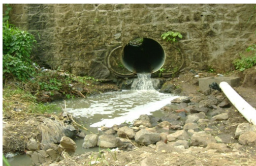
Fig. 3.1 Descarga de aguas residuales.
