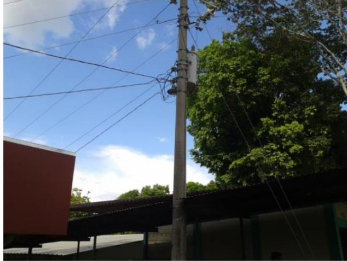
Figura 6. Foto de transformador monofásico No. 2 de FMOcc.
