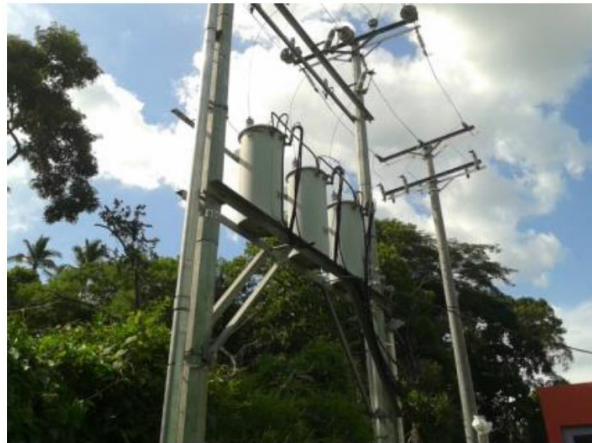
Figura 9. Foto de banco de transformadores Trifásicos No.3 de la FMOcc.
