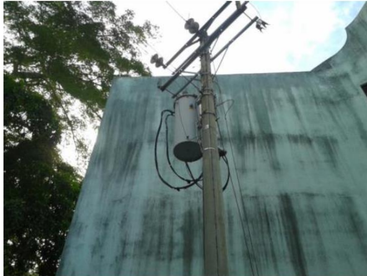
Figura 7. Foto de transformador monofásico No. 3 de la FMOcc.
