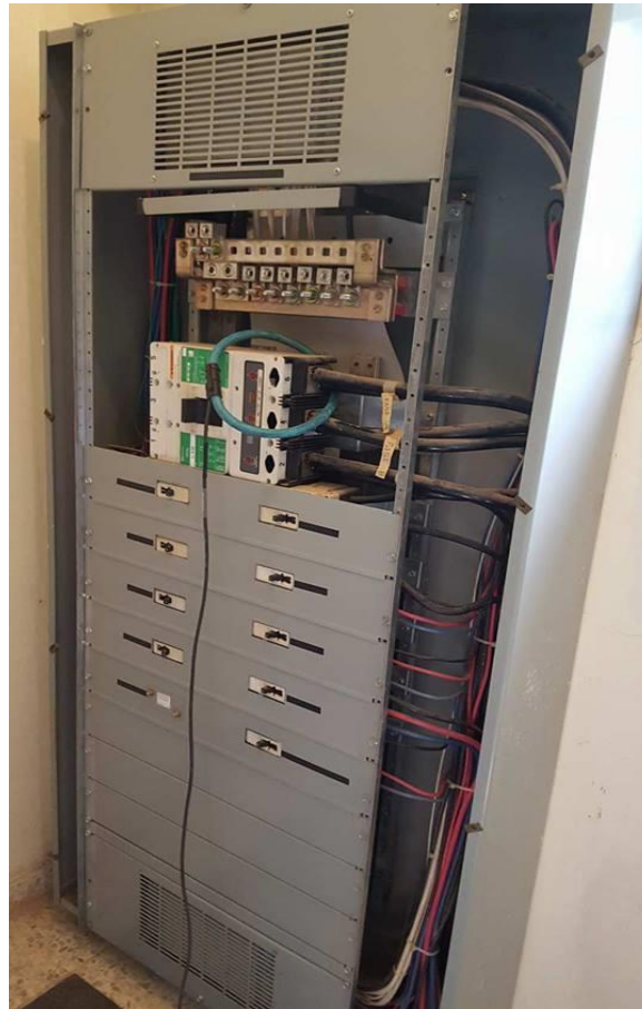
Figura 28. Foto de tablero general de medicina con su protección principal de 600 A.
