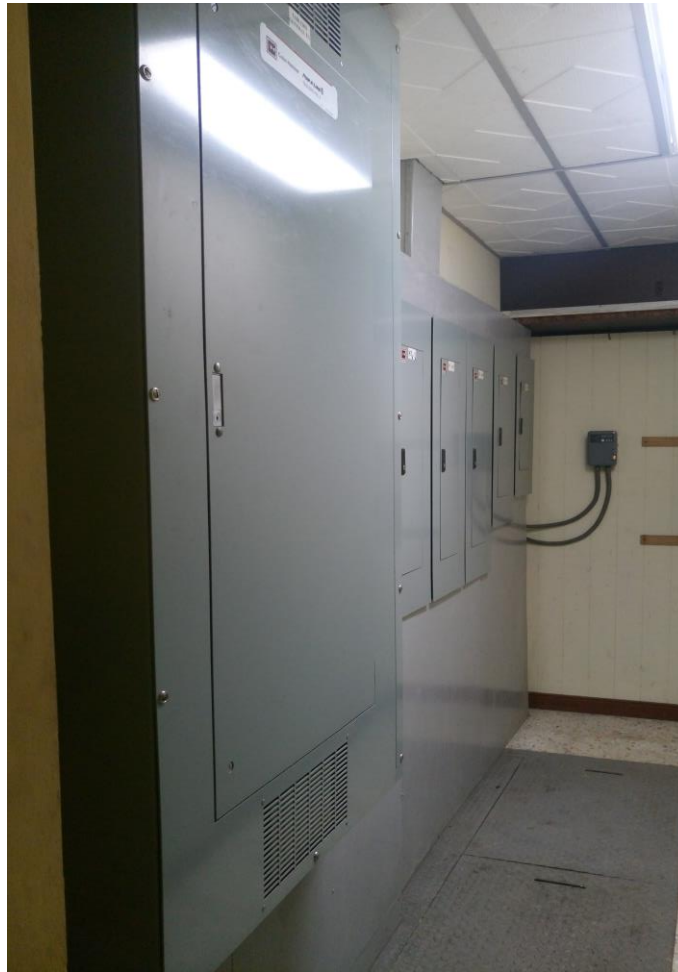
Figura 19. Foto de cuarto de eléctrico de banco de transformadores de Usos Múltiples, FMOcc.
