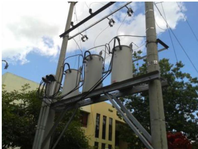
Figura 8. Foto de banco de transformadores Trifásicos No.2 de la FMOcc.
