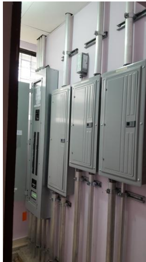
Figura 39. Foto de tableros generales del Edificio de Maestrías.
