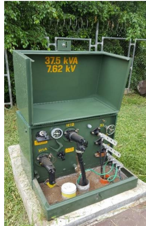
Figura 14. Foto de transformador pedestal monofásico No. 1 de la acometida C.
