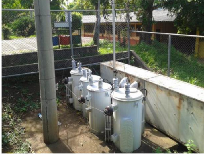
Figura 5. Foto de banco de transformadores trifásicos No. 1 de la FMOcc.
