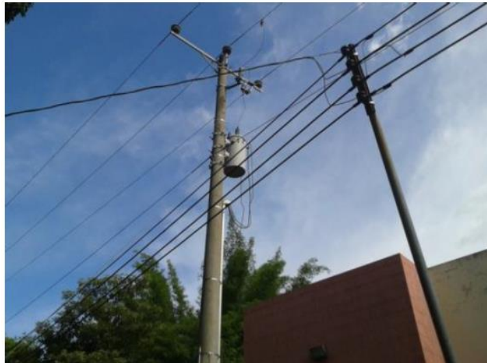
Figura 4. Foto de transformador monofásico No. 1 de la FMOcc.
