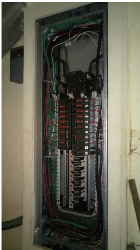
Figura 50. Foto de tablero general de transformador monofásico de auditorium.
