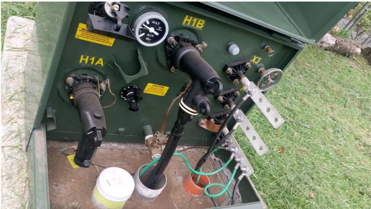
Figura 65. Foto del transformador de acometida "C".
