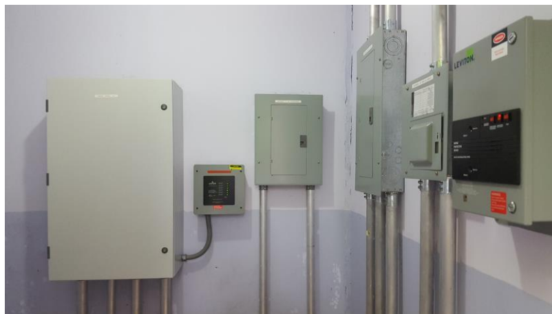
Figura 40. Foto de tableros generales del edificio de Jóvenes Talentos.
