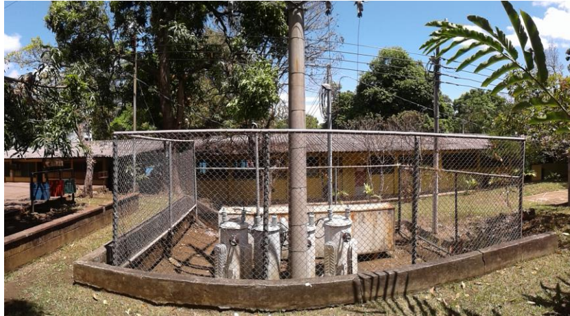
Figura 33. Banco de transformadores trifásico del auditorium.
