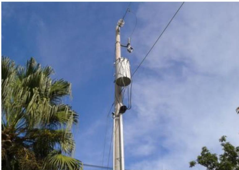
Figura 11. Foto de transformador monofásico No. 4 de la FMOcc.
