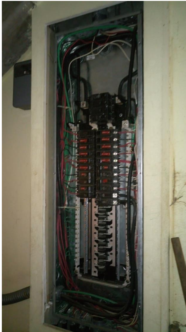
Figura 56. Foto de tablero general de aulas “N”.
