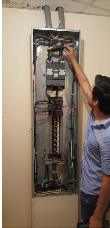
Figura 43. Foto de tablero general del Bunker.
