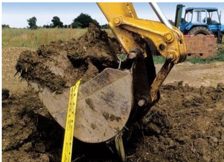
Figura 122. Cinta de precaución es encontrada en sitio de excavación.
