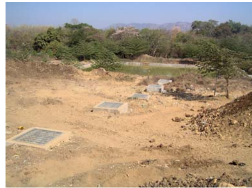
Drenaje y Recolección de Lixiviados
