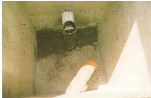
Figura 3.3 Sistema de Pre-tratamiento con Trampa de Grasas
