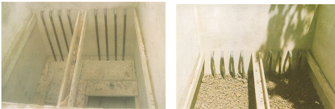
Figura 3.6 Fotografías de un UASB. La primera muestra la entrada del efluente al UASB, mientras que la segunda la salida del efluente.
