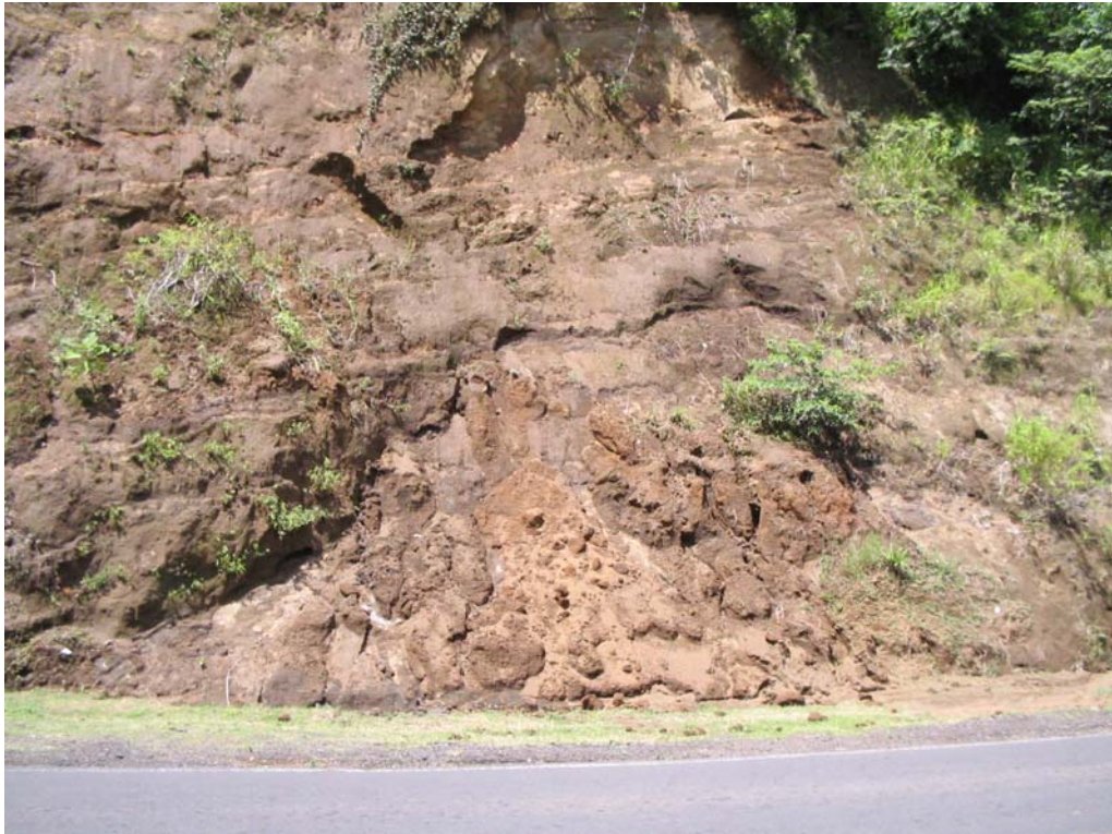
ANEXO B-1 . FALLA DE TALUD EN KM 86 SAN JOSE DE LA MAJA – JUAYÚA.
