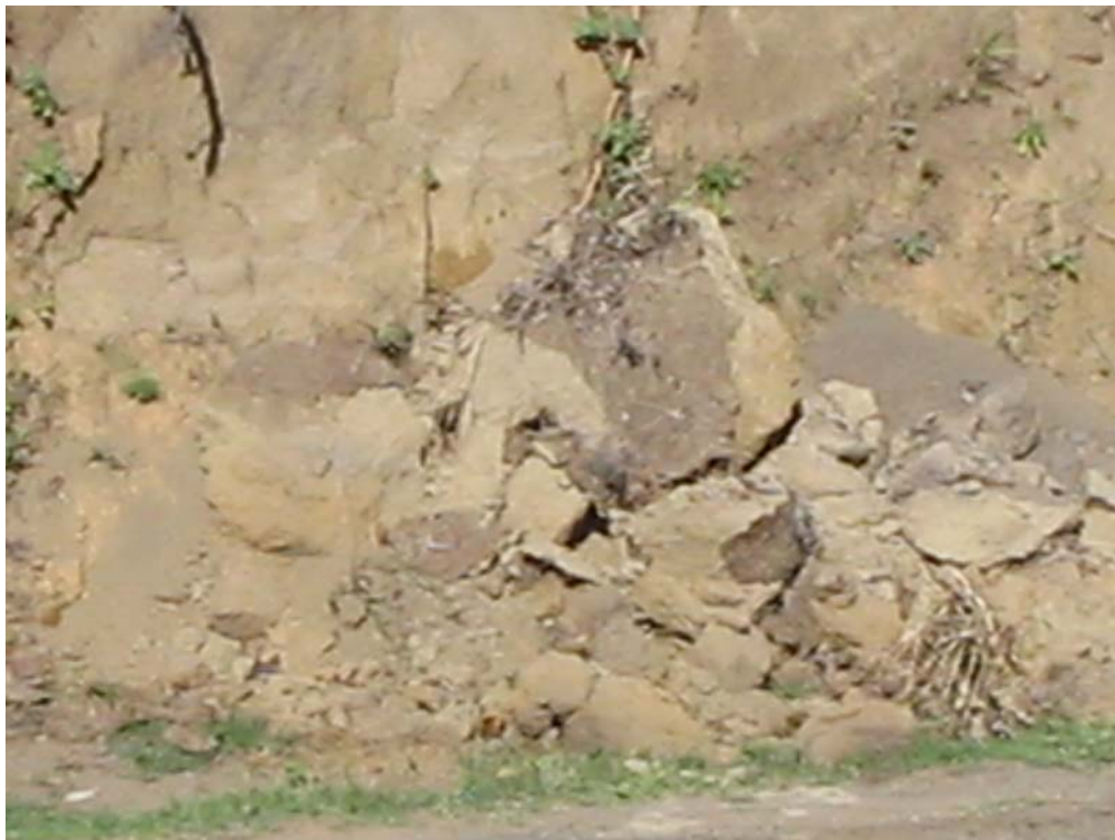
ANEXO B-2 . FALLA TRASLACIONAL TIPICA DE TALUDES EN KM 86 (DESPRENDIMIENTO DE BLOQUES)
