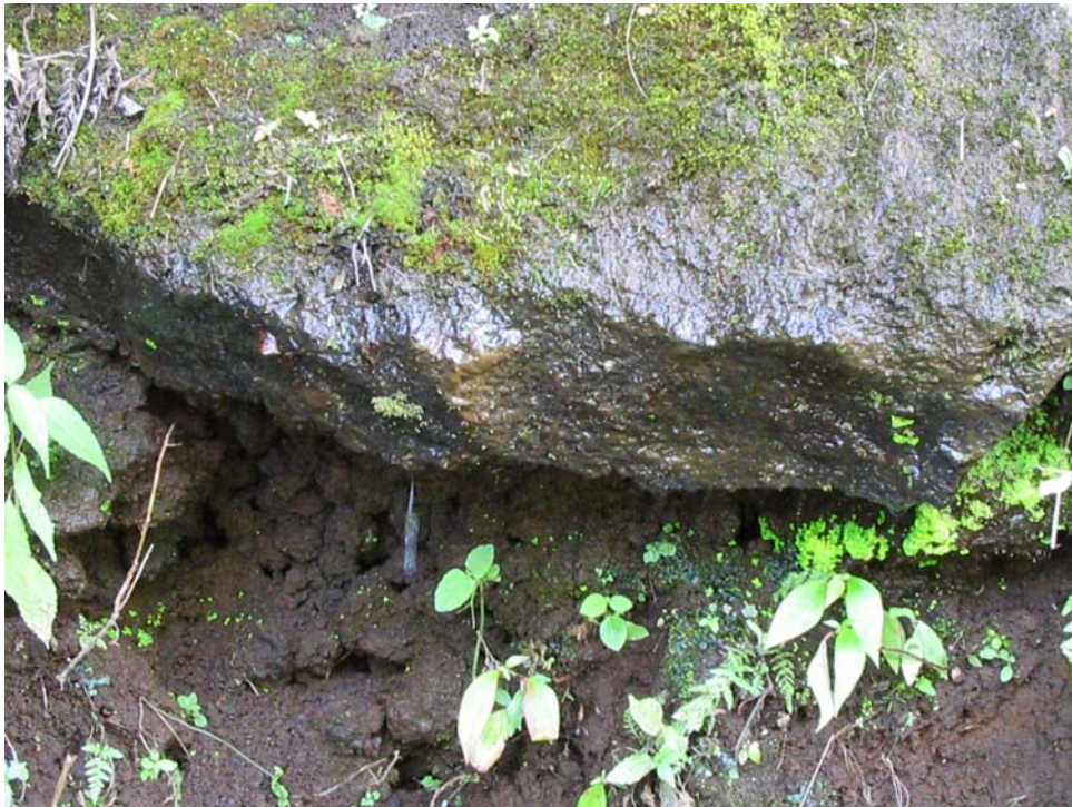
ANEXO B-4 . ROCA FRACTURADA Y PRESENCIA DE HUMEDAD EN LA BASE DE TALUDES KM 89 – 93.
