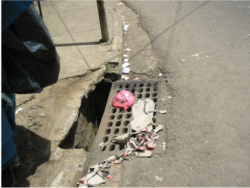
Fotografía 1: Rompimiento y acumulación de basura en caja tragante sobre la Avenida Francisco Menéndez.
