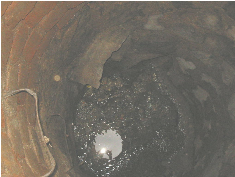
Fotografía 8. Pozo azolvado y dañado 12 Calle Oriente.
