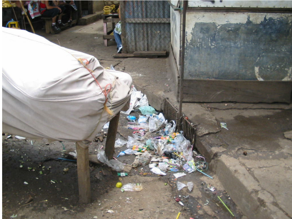
Fotografía 5: Obstrucción de caja tragante que facilita la inundación frente a Mercado Municipal No. 1
