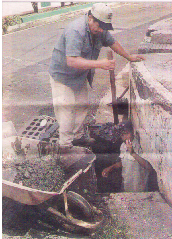
Fotografía 9: Limpieza de tuberías y cajas tragantes por trabajadores de la Alcaldía sobre la 1ª Calle Oriente y 5ª Avenida sur.
