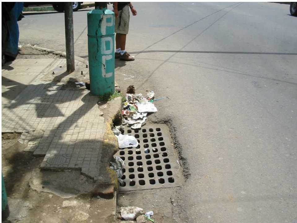
Fotografía 2: Acumulamiento de Basura en caja tragante sobre 6ª Calle.
