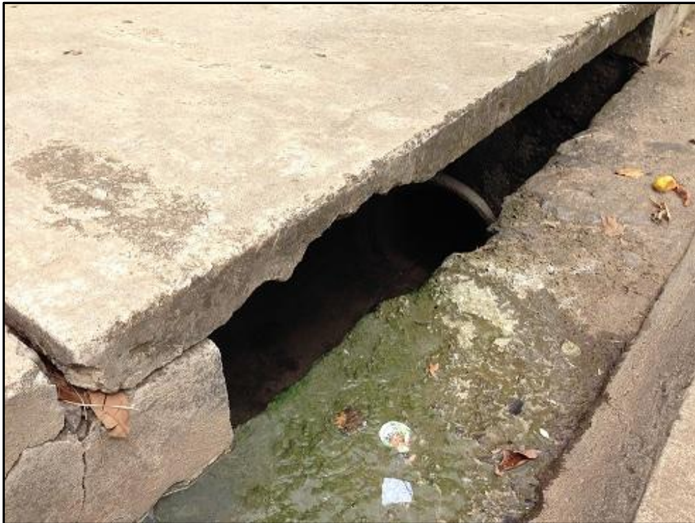
Fotografía 2.1 Captación tipo “Tragante”. Fuente: Autoría propia de grupo de trabajo de grado.
