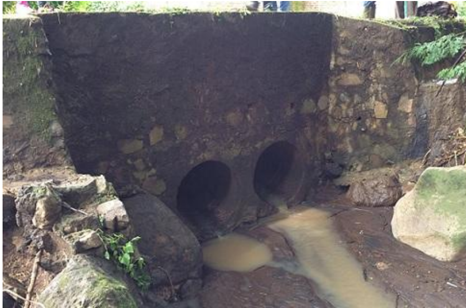
Fotografía 3.3 Quebrada ubicada en calle vieja hacia Atiquizaya con muros de mampostería de piedra existente. (Descarga 2). Fuente: Autoría propia de grupo de trabajo de grado.
