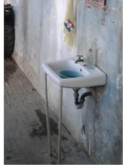
Figura 51 único lavamanos servicios sanitarios
