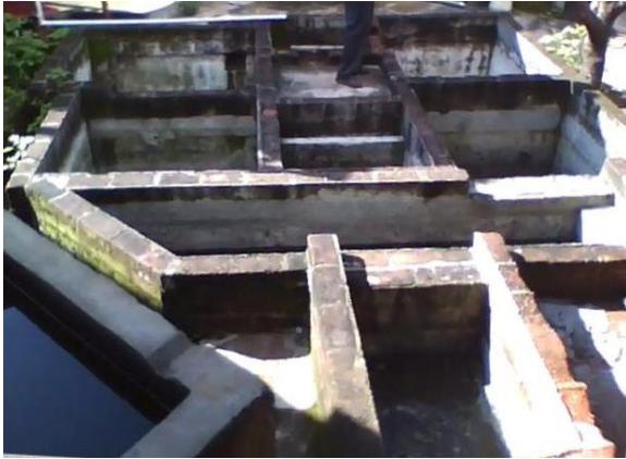
Imagen 7 Colector de aguas residuales
