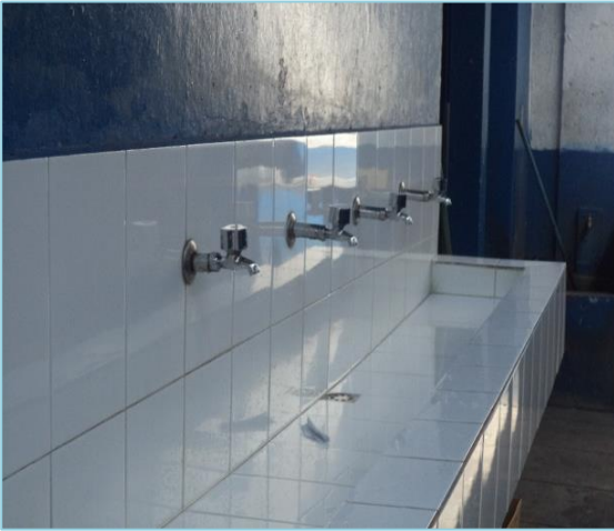
Lavamanos de los servicios sanitarios
