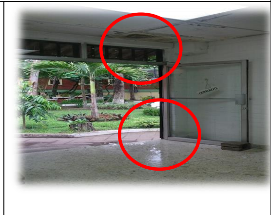
Piso mojado en la entrada principal debido al goteo por mal estado de techo
