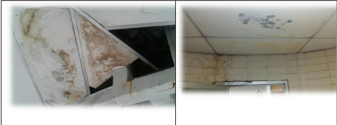
Cielo falso deteriorado por falta de mantenimiento al techo de Bienestar
