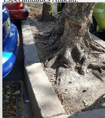
Imagen 43. Raíces superficiales de árbol de Madrecacao en arriate de estacionamiento para médicos. Recuperado: Unidad Médica de Especialidades Atlacatl.
