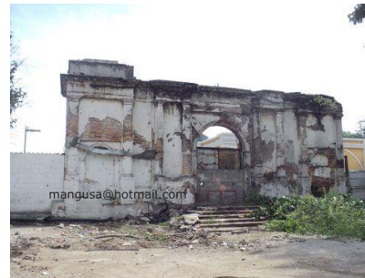
Foto MTC-14, Fachada de La Iglesia San José, en deterioro.
