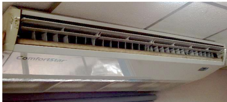
Figura 4.12 Fotografía de aire acondicionado tipo central.
