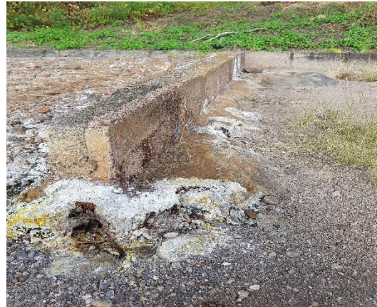
Fotografía 4. Alteración hidrotermal en muro.
