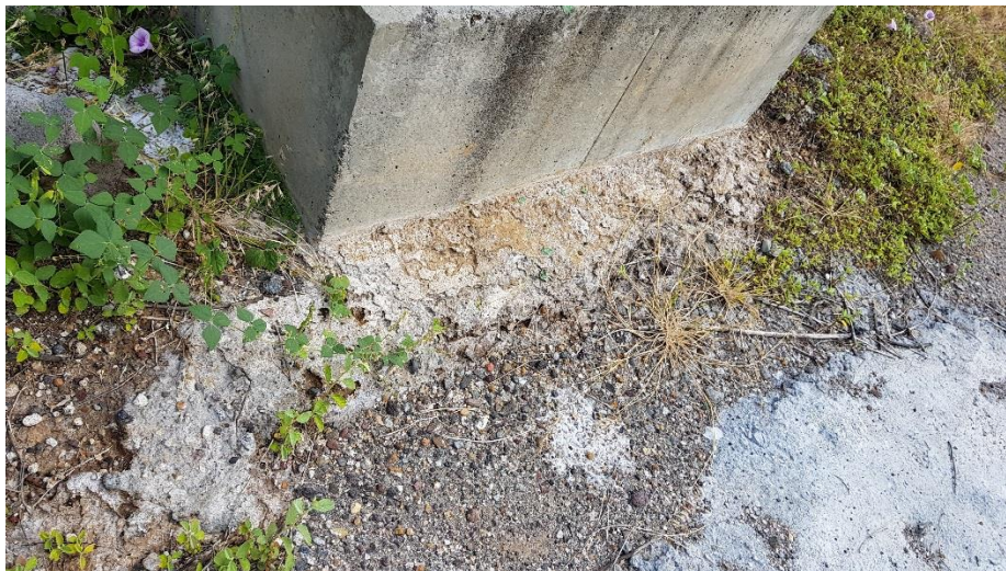
Fotografía 2. Formación de corrosión.
