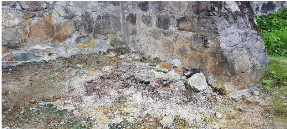
Fotografía 1. Alteración hidrotermal en los cimientos de un muro.
