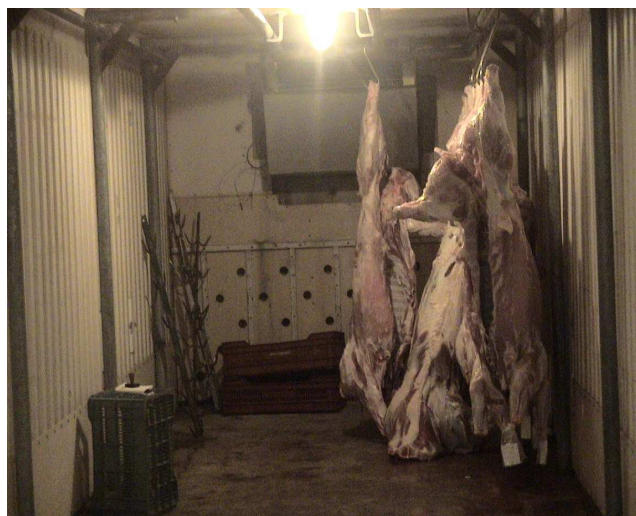
Figura 22- canales en el cuarto frío para prevenir su descomposición.
