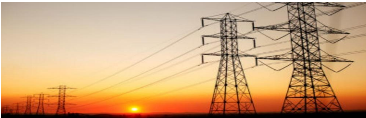
Figura 1.4. Sistema de líneas de transmisión soportado por torres.
