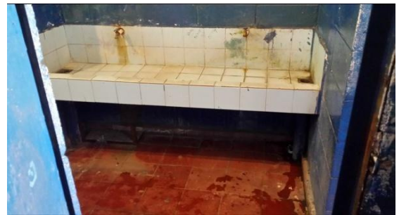
ASEO EN SERVICIOS Y LAVAMANOS
