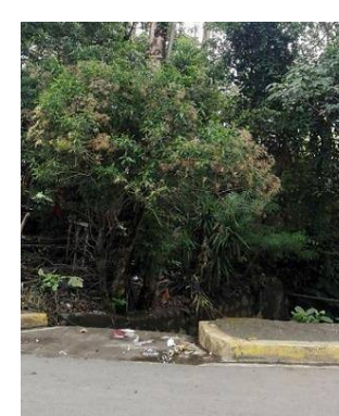
Fotografía 037: Discontinuidad de la acera y zona de riesgo.
