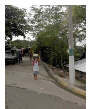
Fotografía 038: Ejemplo de falta de acera peatonal.
