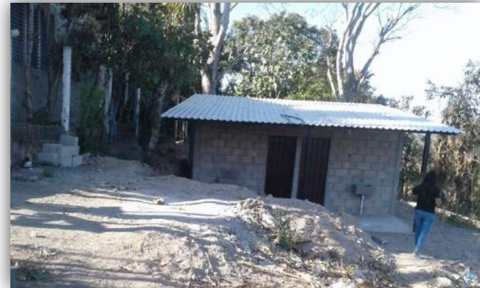
Fotografía 14: Módulo sanitario (incompleto a demoler)
