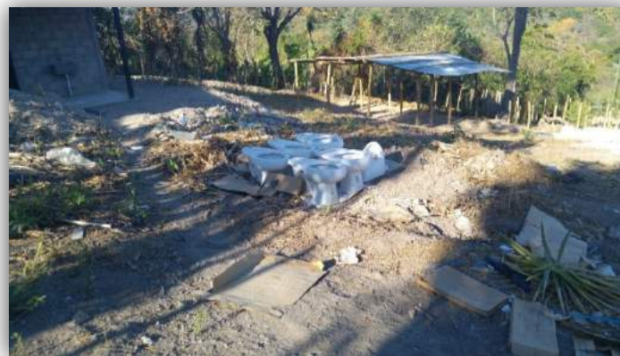
Fotografía 26: Aparatos sanitarios sin instalar
