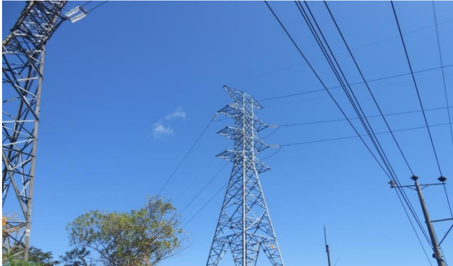
Figura 2.26 Torre de remate nº1 saliendo de la subestación Santo Tomas hacia subestación El Pedregal 27
