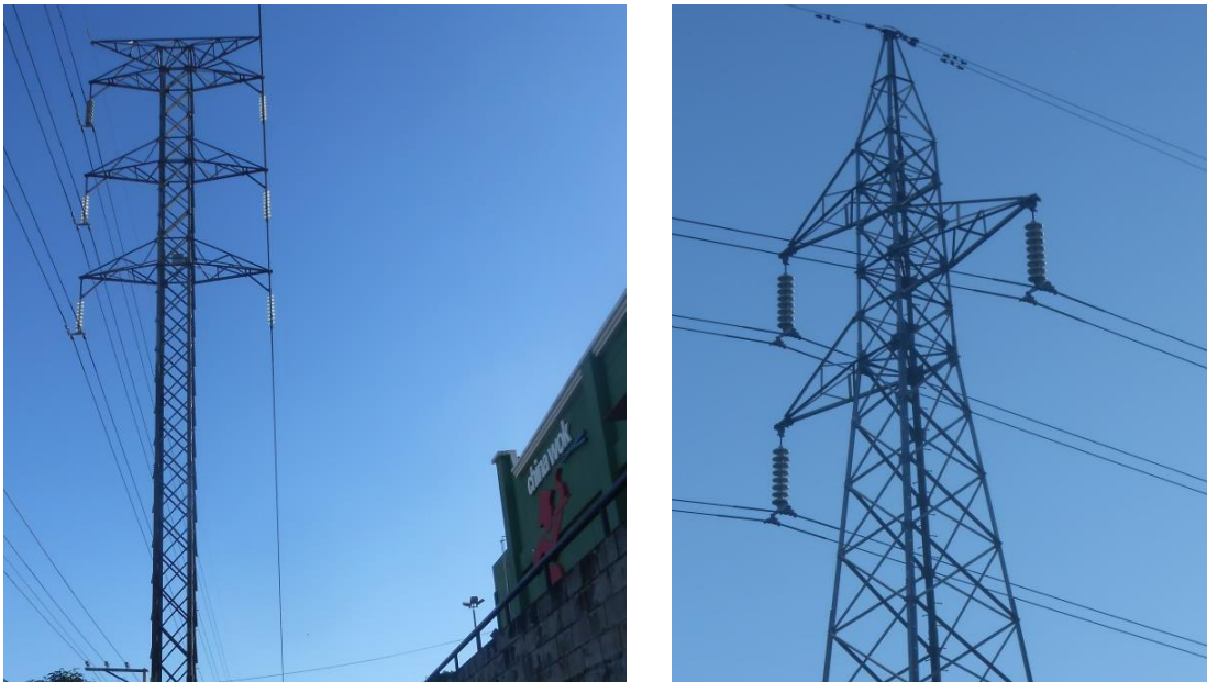
Figura 2.24 torre nº 13 en suspensión, sobre la 17 av. norte ciudad Merliot (a la izquierda). Torre nº 6 en suspensión, línea Soyapango-San Martín (a la derecha). 25
