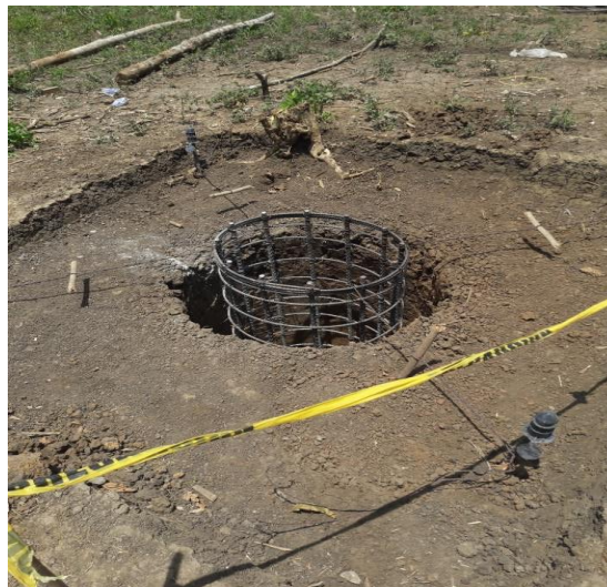
Figura 7.6 Vista del acero de refuerzo en la excavación para cimentación de pata de elefante o acampanada.
