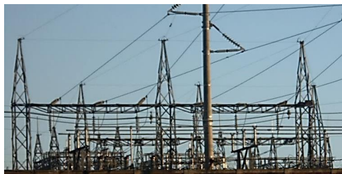
Figura 2.15 Marco de remate, localizado en subestación San Bartolo, colonia San Felipe, Ilopango. 16
