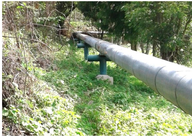
Figura 4. Tubería con fluido geotérmico a alta temperatura. (2016). [Fotografía]. Fuente: Grupo investigador.
