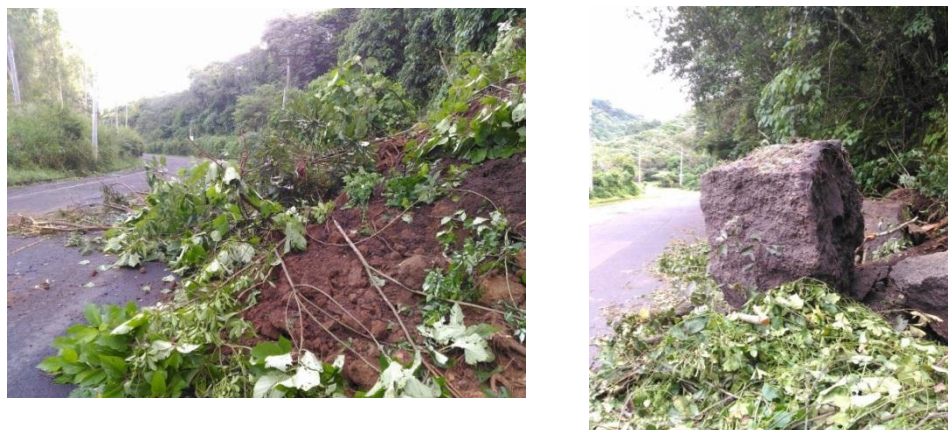
Figura 17. Derrumbes en carretera del Municipio de Ahuachapán que conduce a Ataco
