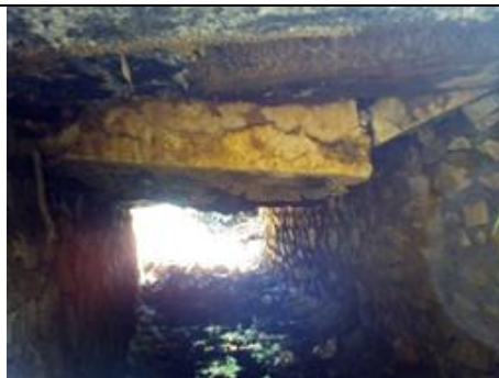
Figura 18. Puente quebrado de la parte de abajo en el Cantón El Junquillo.
