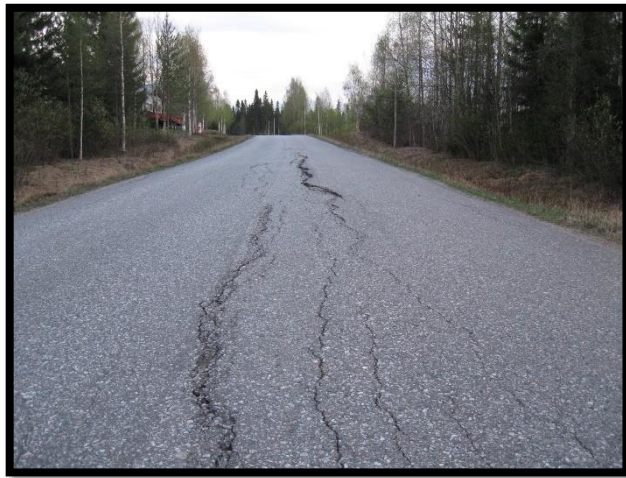
Figura: 0.5: Fisura Longitudinal.
