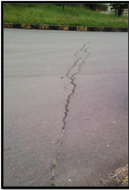
Figura: 0.4: Fisura Transversal.
