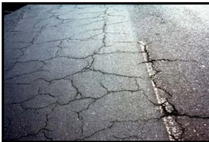
Figura: 0.2: Fisura en Bloque.
