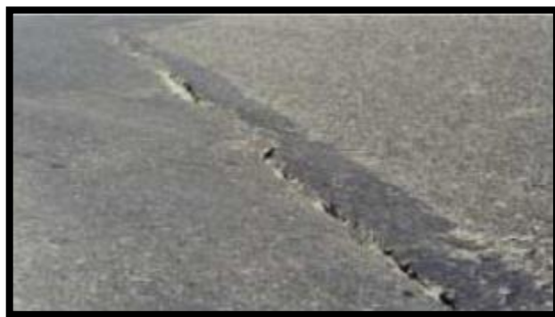
Figura: 0.6: Fisuras por deflexión de Juntas.
