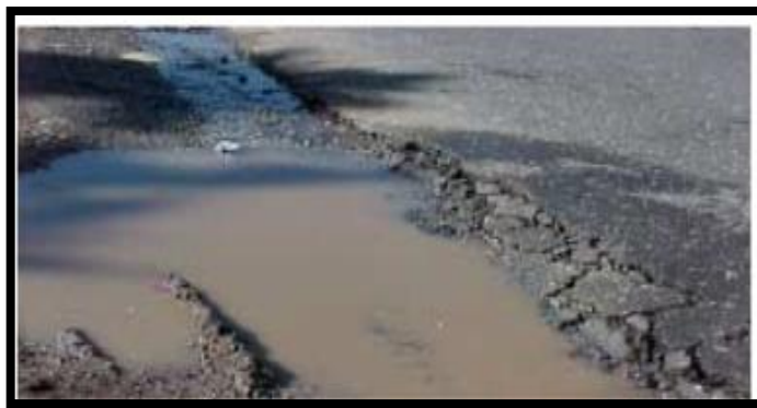
Figura: 0.14: Desintegración de Bordes con acumulación de agua.
