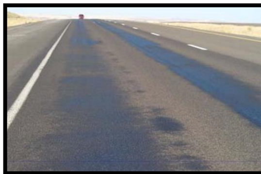
Figura: 0.15: Exudación de Asfalto.
