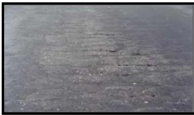
Figura: 0.3: Fisura en Arco.
