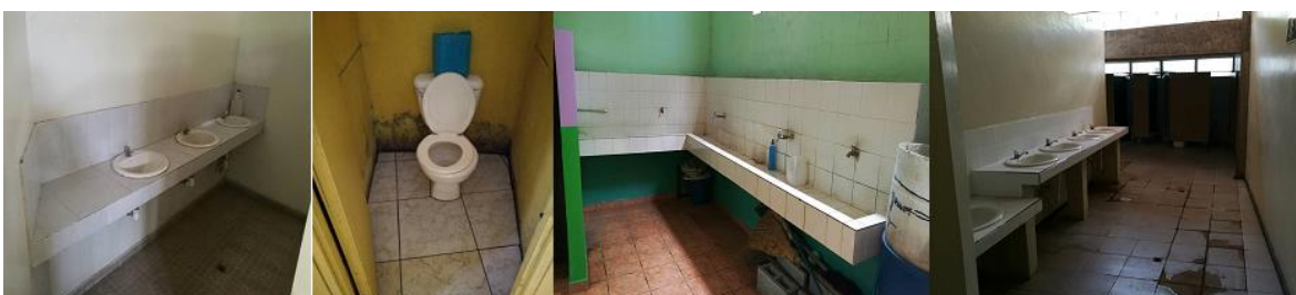
Ilustración 29 Servicios sanitarios y lavamanos en los parques.
