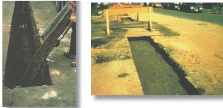
Figura 6. Relleno de una zanja con MBRC mediante vertido directo desde camión. A la derecha se aprecia el MBRC alcanzando la cota inferior
