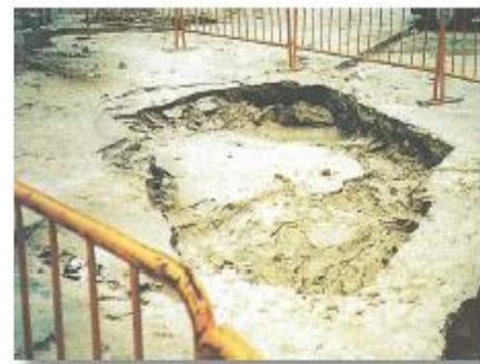
Figura 4. Socavón en la calzada
