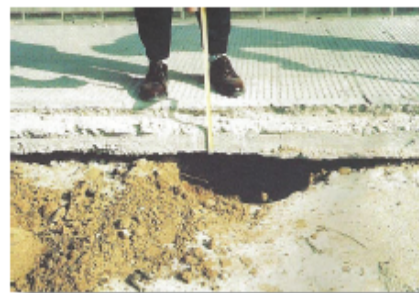
Figura 1b. Socavón bajo la acera provocado por una ejecución inadecuada de los rellenos de las zanjas
