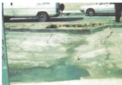
Figura 1a. Hundimiento de calzada y acera provocados por una ejecución inadecuada de los rellenos
