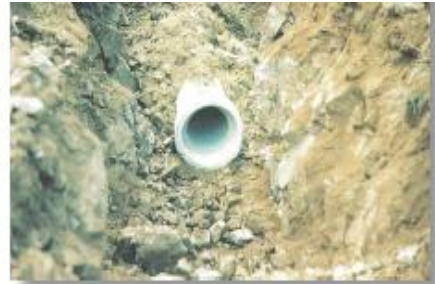
Figura 3. Relleno de una zanja con material sin seleccionar
