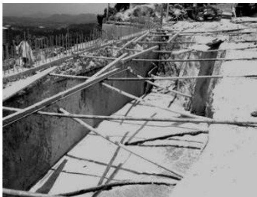
Figura 2.11 Relleno entre muro de contención y derrumbe. 45
