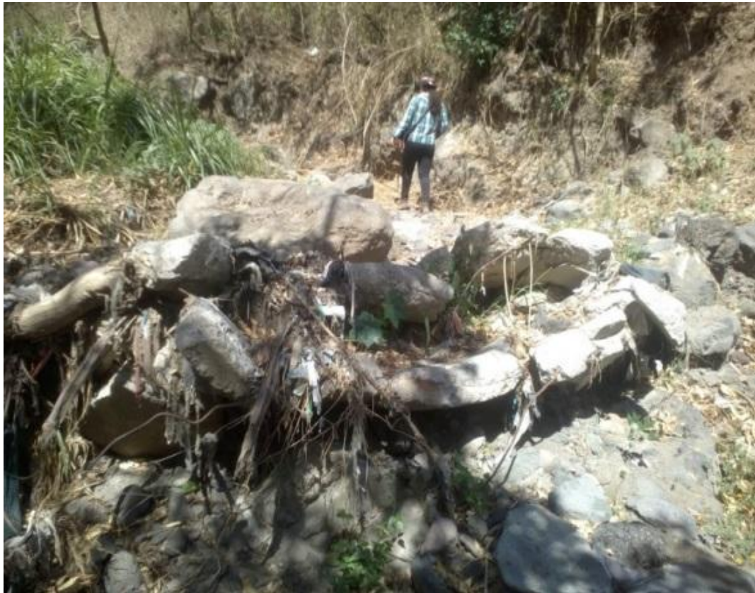
Figura 3.3.7 Restos de la tubería de concreto con la que se intervino la Quebrada Las Lajas San Salvador.
