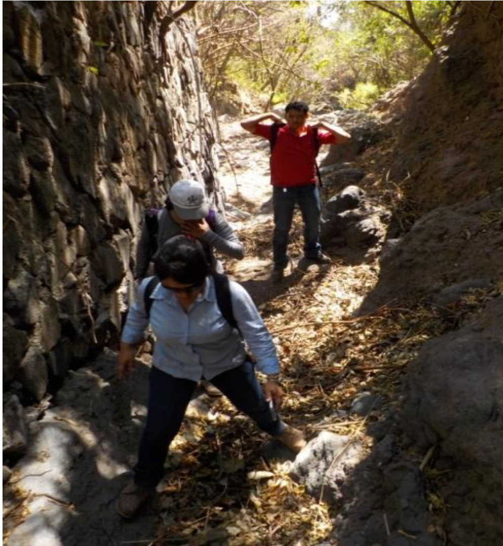
Figura 3.3.8 Muro de mampostería que estrecha significativamente el cauce de la Quebrada Las Lajas San Salvador.
